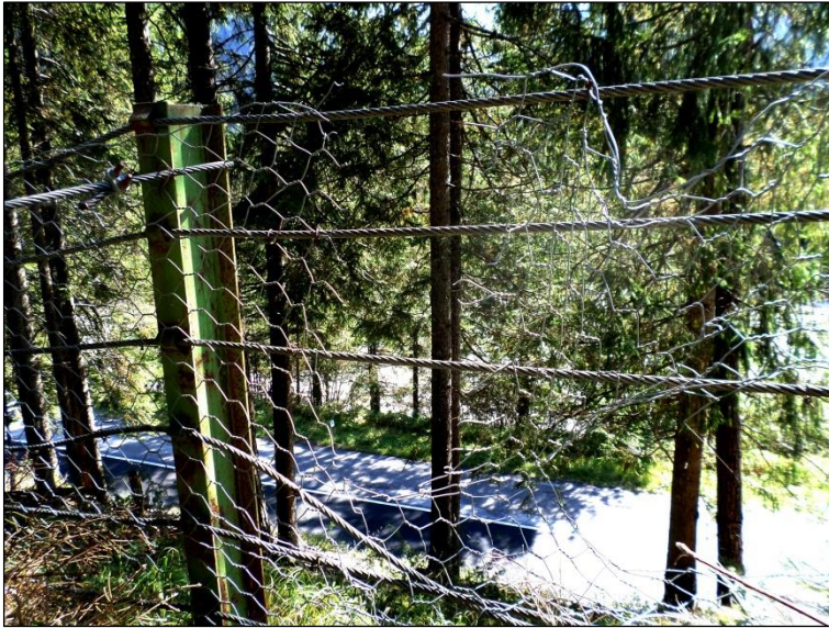
Figura 61: In località Stabin la rete paramassi presente è danneggiata.
