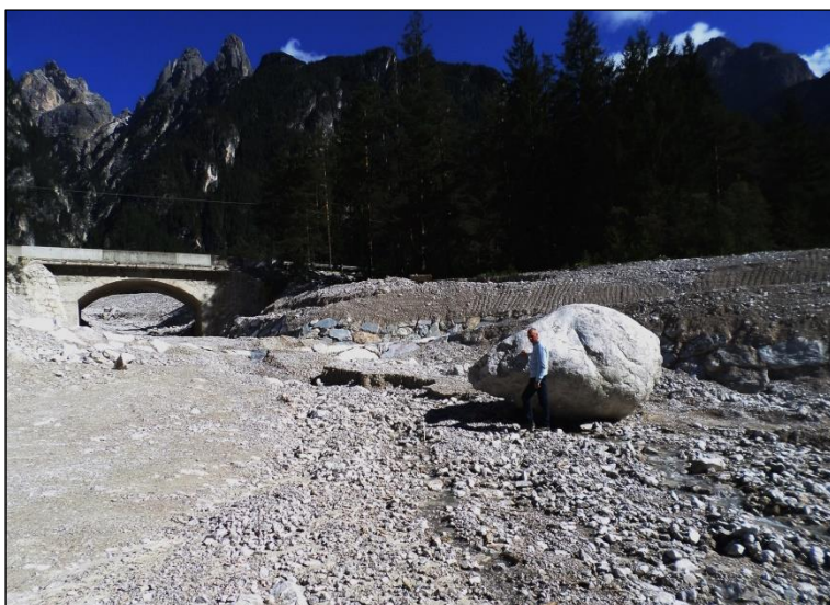
Figura 46: Foto scattata dall'alveo dell'Ansiei verso Nord. Il letto alla confluenza con il Gravasecca è qui già stato liberato e le sponde quasi ricostruite. Il masso ha un volume di circa 15\text{ m}^3 .
