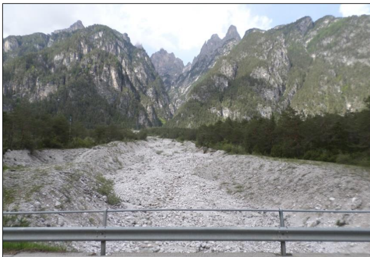
Figura 20: Solco di erosione del Gravasecca visto dalla strada regionale 48. L'erosione sulle sponde è molto accentuata.
