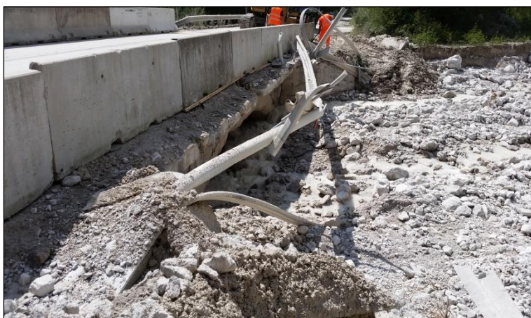
Figura 43: Il ponte del Gravasecca è stato in parte danneggiato. Il detrito depositato nell'evento di colata ha completamente ostruito la luce.
