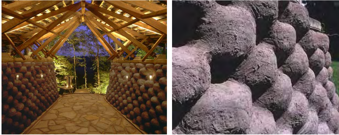
Fig. 28. Yancy Tire Chapel, 1995: Le pareti definitive sono costruiti di 900 pneumatici imballati e compattati con la sporcizia, legati insieme con armature e stuccate. Le travi del tetto sono di pino e sono state recuperate da una vecchia casa. Fonte: www.ruralstudio.org
