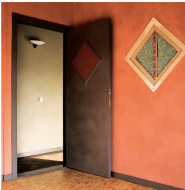
Fig. 5. Dettaglio di una partizione interna verticale al livello superiore che mette in evidenza l'isolamento di polietilene riciclato. Fonte: www.recyhouse.be
