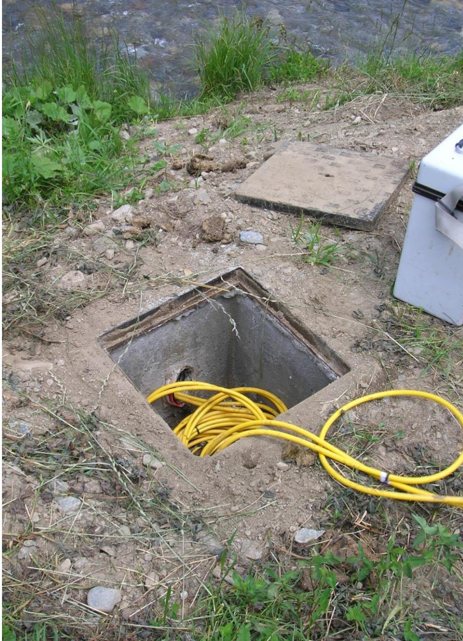
Fig. 3.13: Pozzetto da dove fuoriescono i cavi da pozzo.
