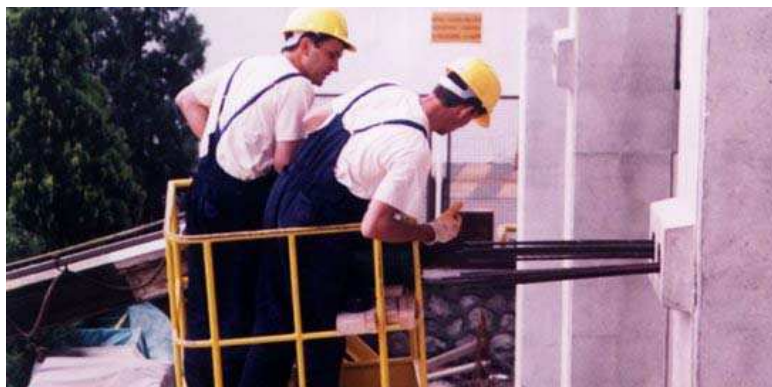
Figura 2.10: Operatori addetti alla tesatura di funi post-tese per sistemi di collegamento componibili ad elevata duttilità
