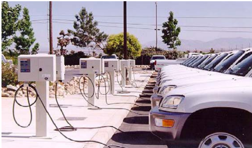
Figura 1.9: Colonnine di ricarica per veicoli elettrici
