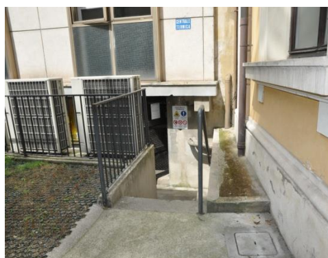
Figura 5.36: Centrale termica - Ingresso dal cortile interno
