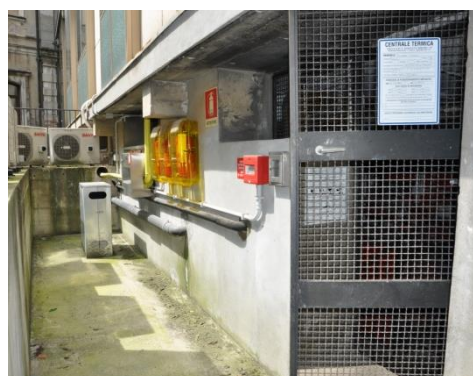
Figura 5.37: Centrale termica nel piano interrato - Corpo B 2
