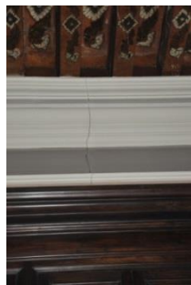
Figura 5.29: Fessurazione Piano primo - Blocco A
