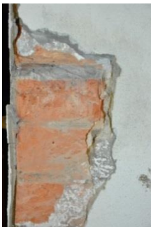
Figura 5.24: Lacuna Interrato - Corpo A
