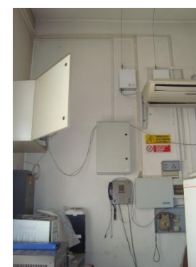
Figura 5.40: Impianti elettrici e canalizzazioni - Corpo D
