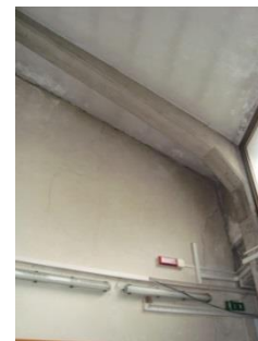
Figura 5.31: Fessurazione Secondo piano -Blocco D
