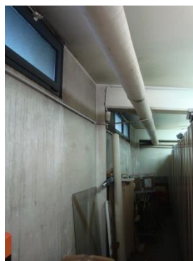
Figura 5.34: Canalizzazioni nel piano interrato - Corpo B
