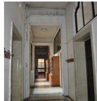
Figura 5.27: Colatura Piano terra - Corpo D
