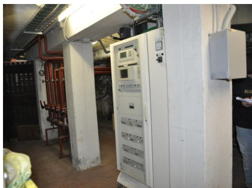
Figura 5.33: Centralina nel piano interrato - Corpo A
