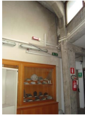
Figura 5.42: Impianti "fuori traccia" – Corpo B 2
