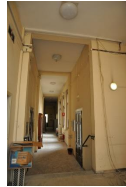
Figura 5.43: Impianti fuori traccia – Corpo D
