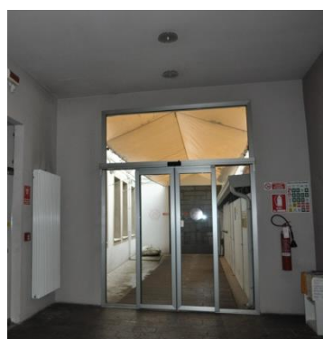
Figura 5.38: Sistema anticendio (idranti) e di riscaldamento - Ingresso da via G. Matteotti
