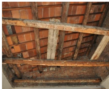
Figura 5.30: Marcescenza teste delle travi e svergolamento Secondo piano - Blocco D
