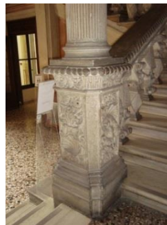
Figura 5.26: Deposito superficiale Piano terra - Corpo A
