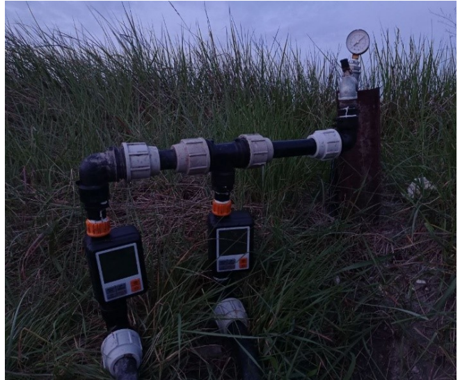
Figura 16: Tmer posti all'uscita della condotta.
