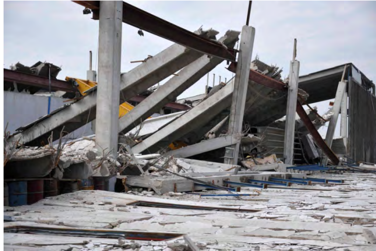
Fig. 3 – Crollo edificio industriale, Emilia Romagna 2012
