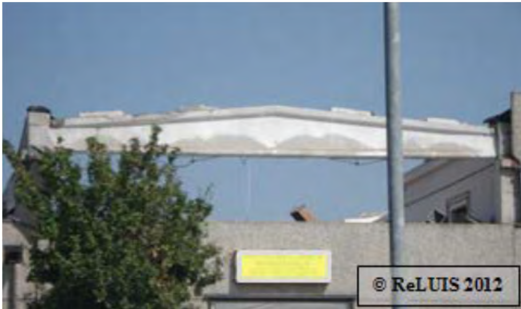
Fig. 19 - Collasso dei pannelli orizzontali di tamponamento
