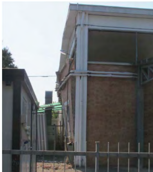
Fig. 22 – Crisi fuori dal piano di una tamponatura in laterizio
