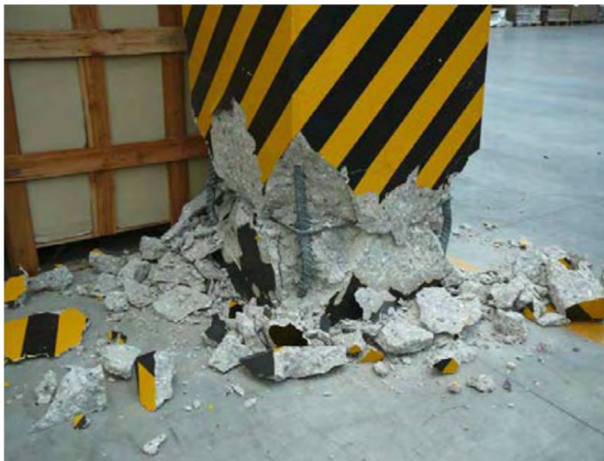
Fig. 26 – Cerniera plastica alla base del pilastro
