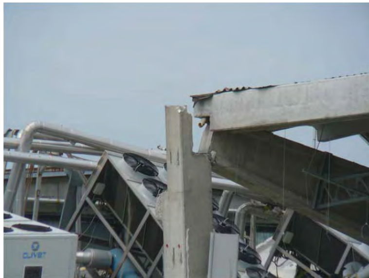
Fig. 16 - Perdita di appoggio della capriata
