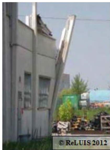
Fig. 23 – Perdita di verticalità del pilastro per rottura alla base
