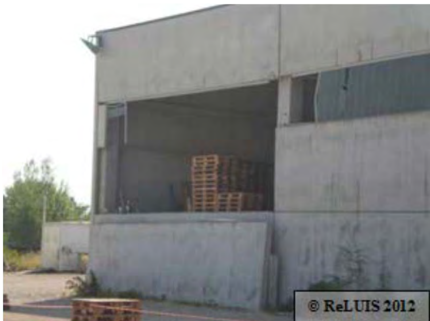
Fig. 20 - Collasso dei pannelli orizzontali di tamponamento
