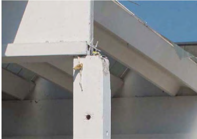
Fig. 15 - Perdita di appoggio della trave con rottura della connessione
