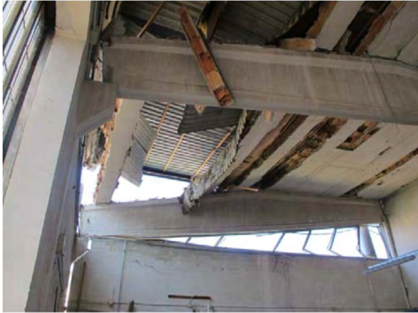
Fig. 13 - Perdita di appoggio della trave e collasso della copertura
