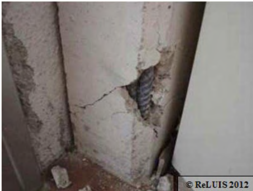
Fig. 25 – Espulsione del copriferro alla base del pilastro
