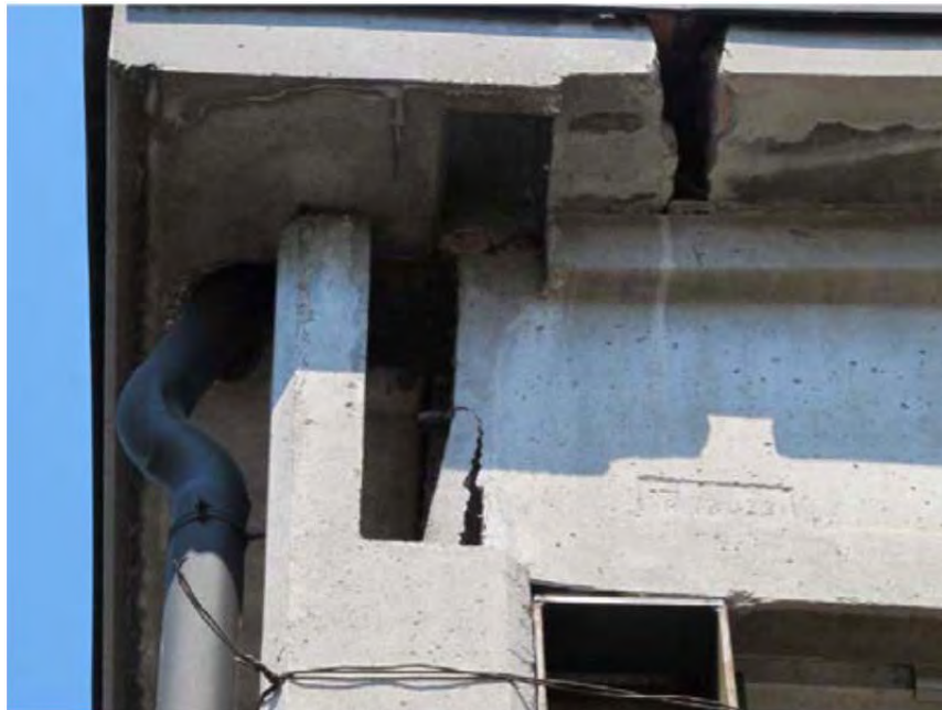
Fig. 14 - Perdita parziale di appoggio della trave
