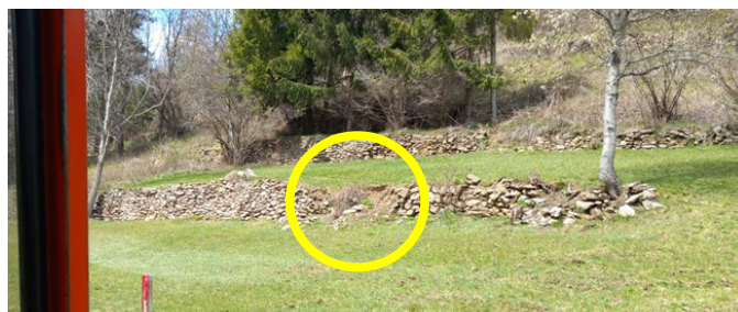
Figura 5.10: Effetto dell'abbandono sui muri di sostegno. Vista frontale di un muro di sostegno della zona più a valle dell'area di studio, proprio dove si trova il maggior accumulo dei flussi. Il collasso dei muri è esacerbato dal transito degli animali selvatici e da altri trigger. (Foto: autore, 2023)
