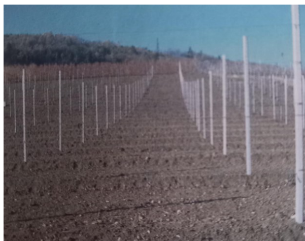
Figura 4.2: Realizzazione di un nuovo impianto di melo in pendio in bassa Val di Sole. Si noti il gradonamento, sulla cui rampa di sostegno sarà piantumato il filare. (da Pantezzi, 2007)
