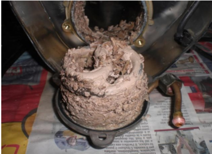
Figura 7: Boiler intasato da calcare.
