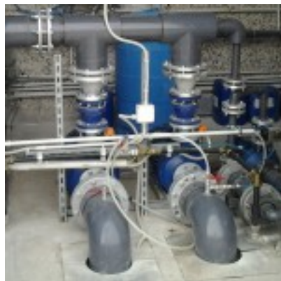
Figura 1: Pompe di una vasca di pompaggio.
