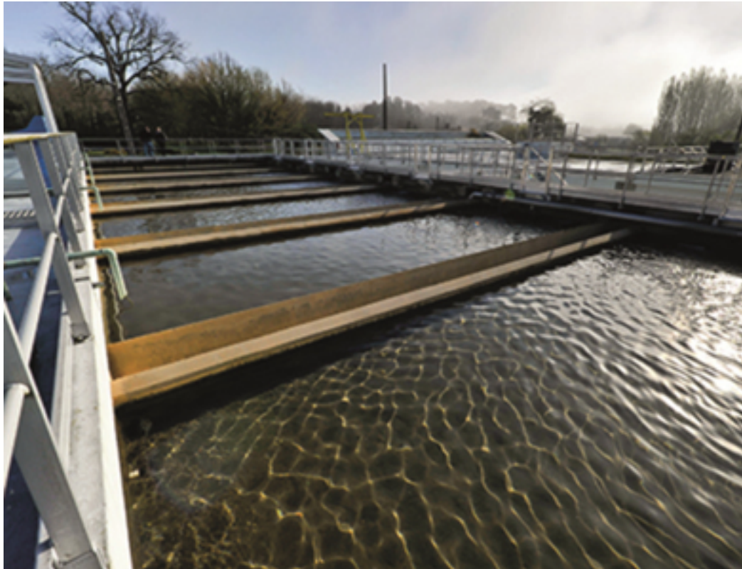
Figura 6: Vasche che formano i filtri Acquazurr V.
