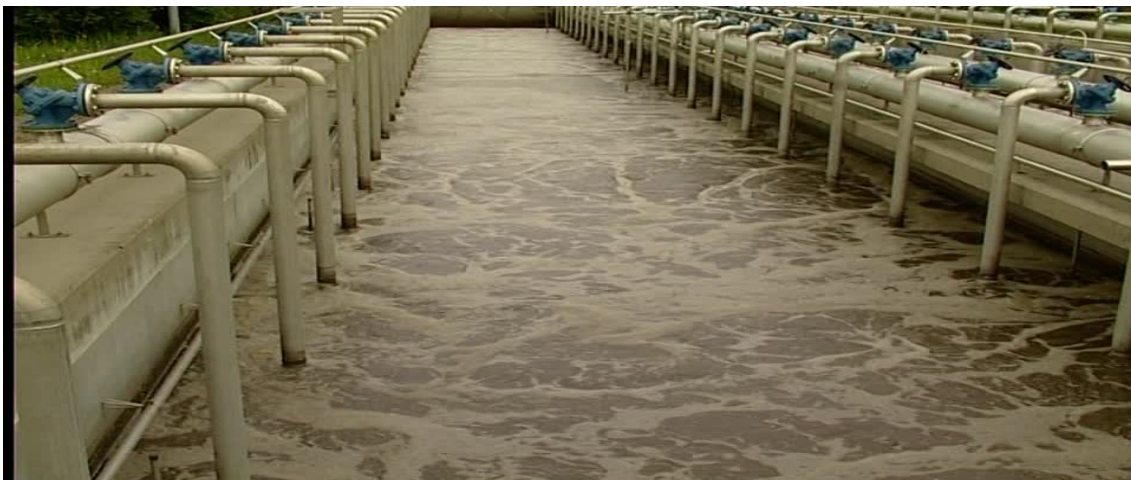
Figura 11: Esempio di bacino di aerazione.
