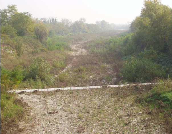
Foto 12a: Torrente Leogra - Sbarramenti non superabili dall'ittiofauna
