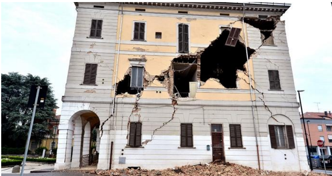
Figura 2.3 – Collasso della struttura per sfilamento del solaio dal piano di appoggio
