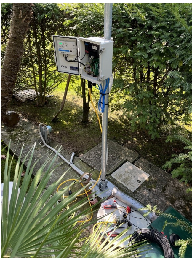
Figura 5.12.2: Stazione di monitoraggio installata nel pozzo Tacchetto 3.
