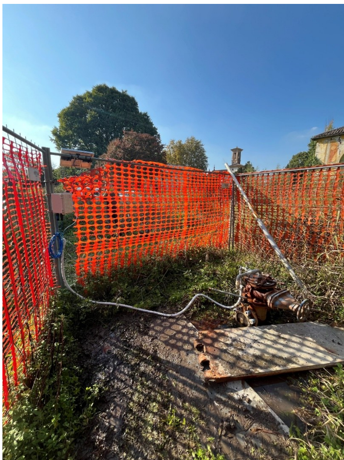
Figura 5.14.1 Stazione di monitoraggio installata nel pozzo Ca' Oddo.
