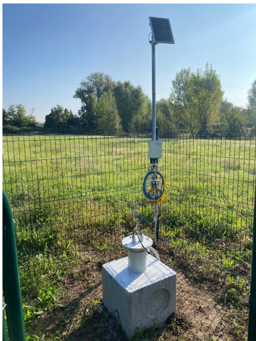
Figura 5.11.1: Stazione di monitoraggio installata nel pozzo San Pelagio 1.
