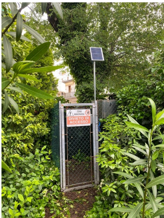
Figura 5.9.1: Stazione di monitoraggio installata nel pozzo Barillari 2.
