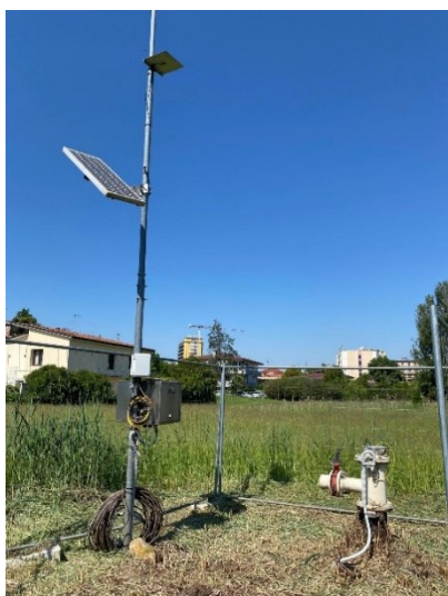
Figura 5.7.1: Stazione di monitoraggio installata nel pozzo Mezzavia 4.
