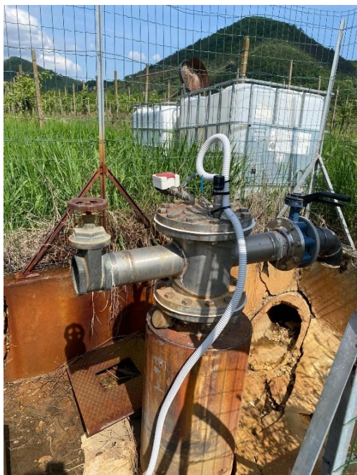
Figura 5.3.1: Stazione di monitoraggio installata nel pozzo Regazzoni 1.
