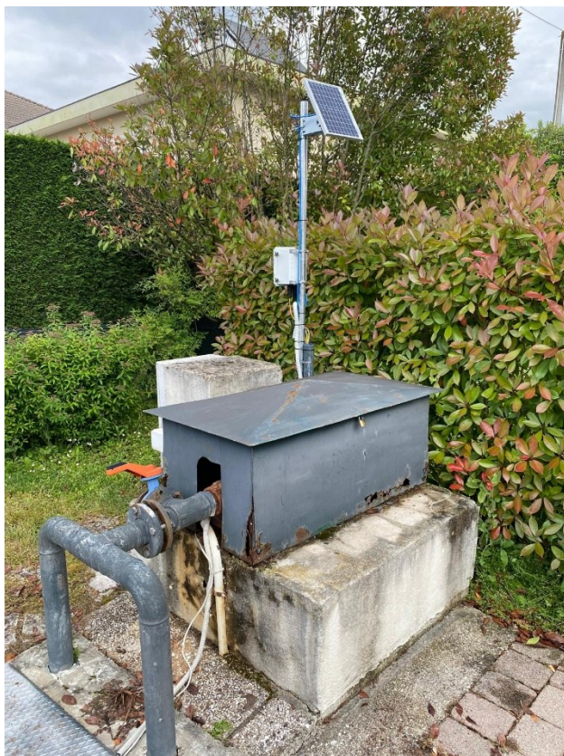
Figura 5.10.1: Stazione di monitoraggio installata nel pozzo Bonato 5.
