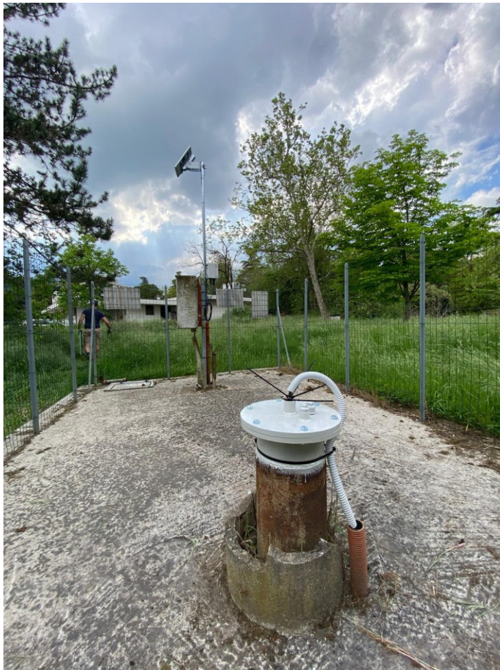
Figura 5.5.1: Stazione di monitoraggio installata nel pozzo Commodore 5.
