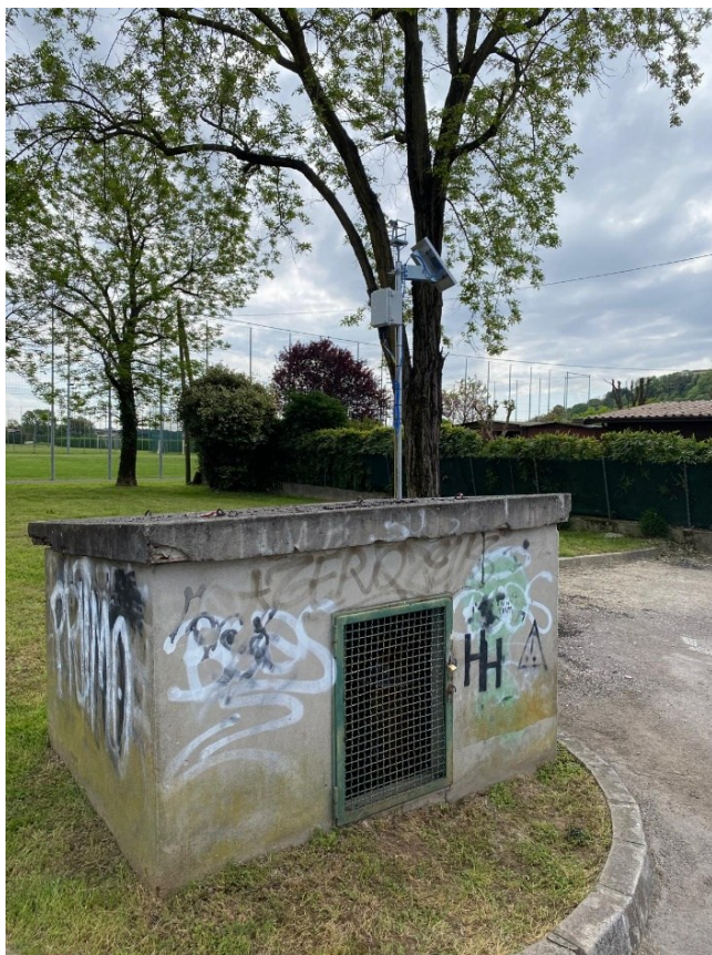
Figura 5.4.1 Stazione di monitoraggio installata nel pozzo Buja Monteortone 11.
