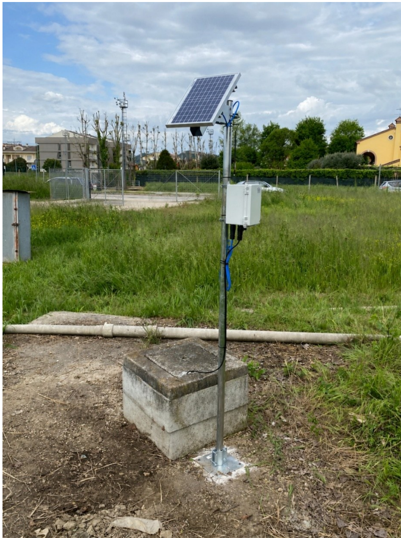
Figura 5.1.1: Stazione di monitoraggio installata nel pozzo Romana 1.
