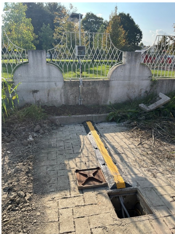
Figura 5.13: Stazione di monitoraggio installata nel piezometro P58.
