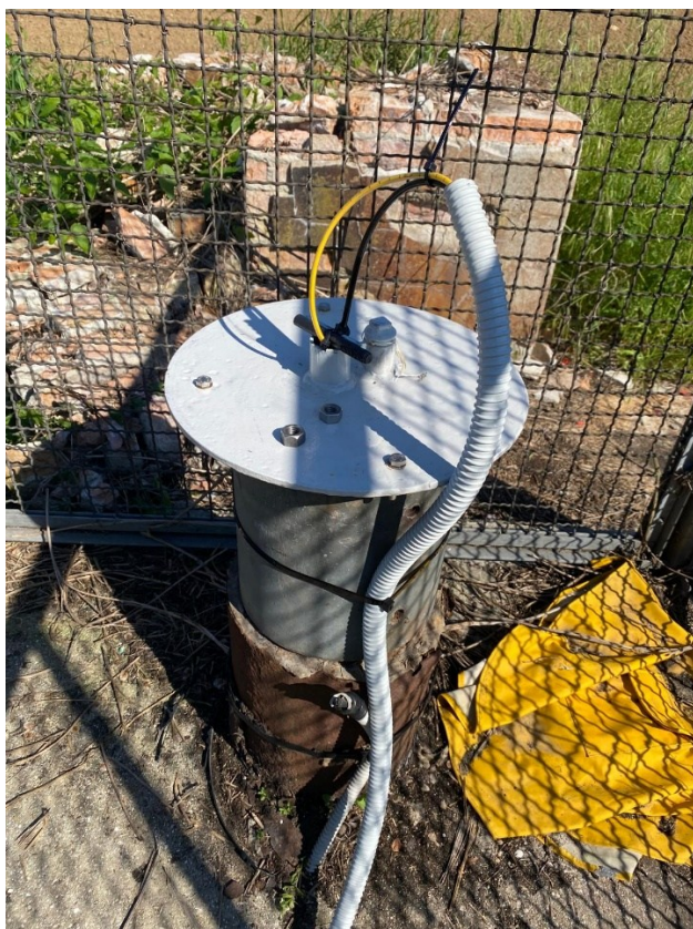
Figura 5.8.1: Stazione di monitoraggio installata nel pozzo Fonte Colli Euganei 1.
