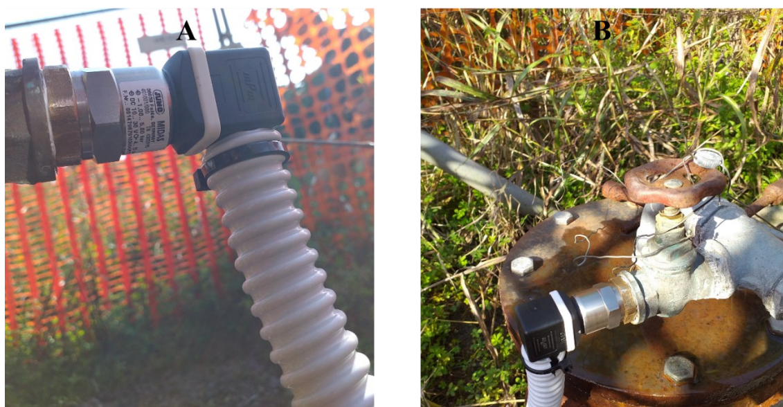
Figura 3.3.3.1: Sensore di pressione (A) installato direttamente sulla testa pozzo (B).
