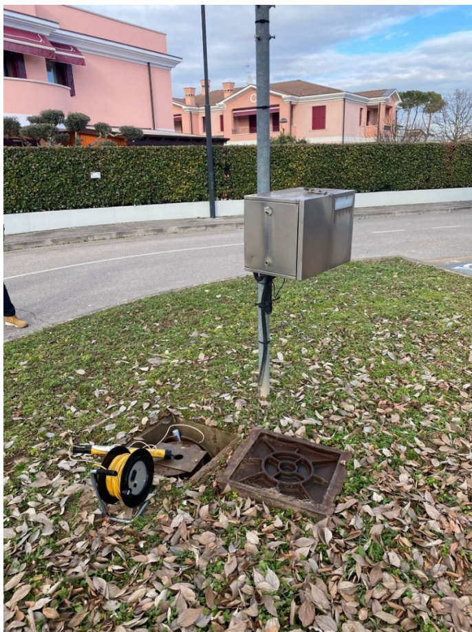
Figura 5.2.1: Stazione di monitoraggio installata nel pozzo Rigati 2.
