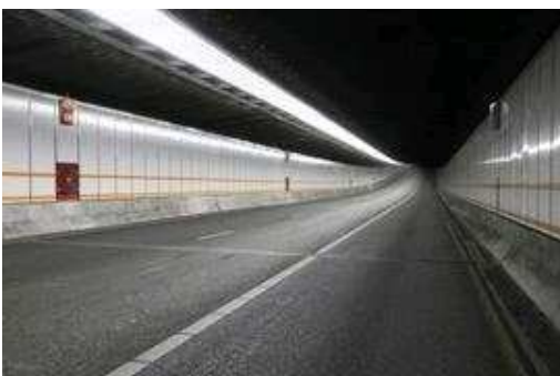
Figura 2.6: illuminazione a LED nel tunnel Vlakte
