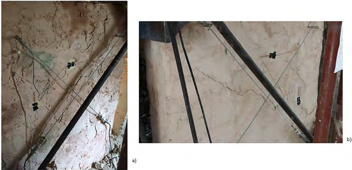
Figura 140 – Quadro fessurativo a rottura: a) lato a; b) lato b
