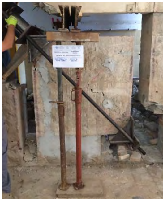
Figura 132 – Quadro fessurativo (spostamento 15 mm) lato B
