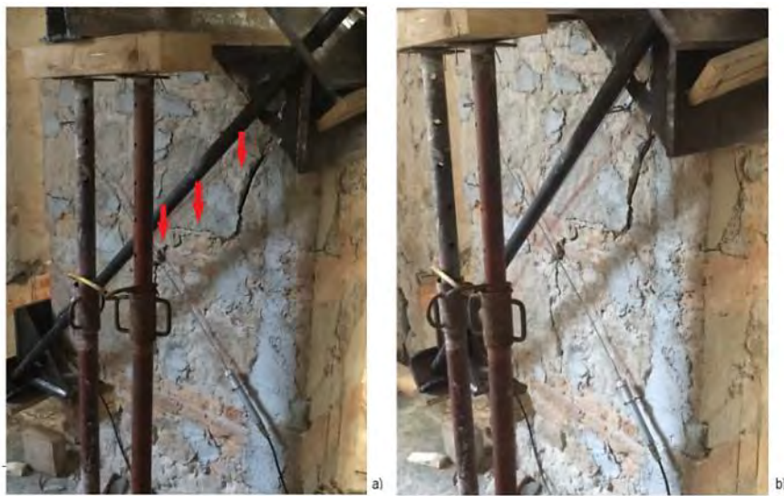
Figura 131 – Quadro fessurativo spostamento 15 mm lato A
