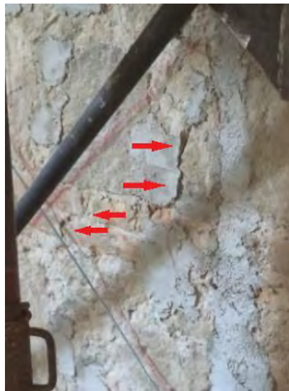
Figura 129 – Localizzazione prime fessurazioni lato A
