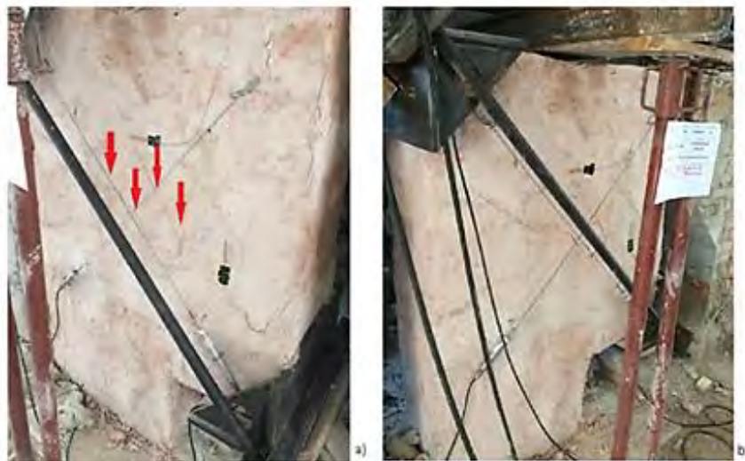
Figura 139 – Evoluzione del quadro fessurativo lato B
