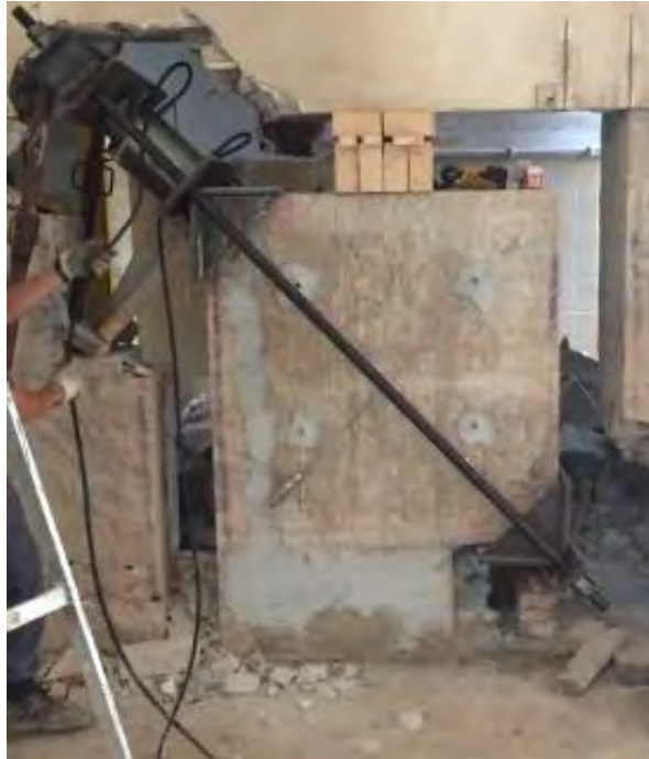
Figura 126 – Disposizione della strumentazione (lato B-androne)
