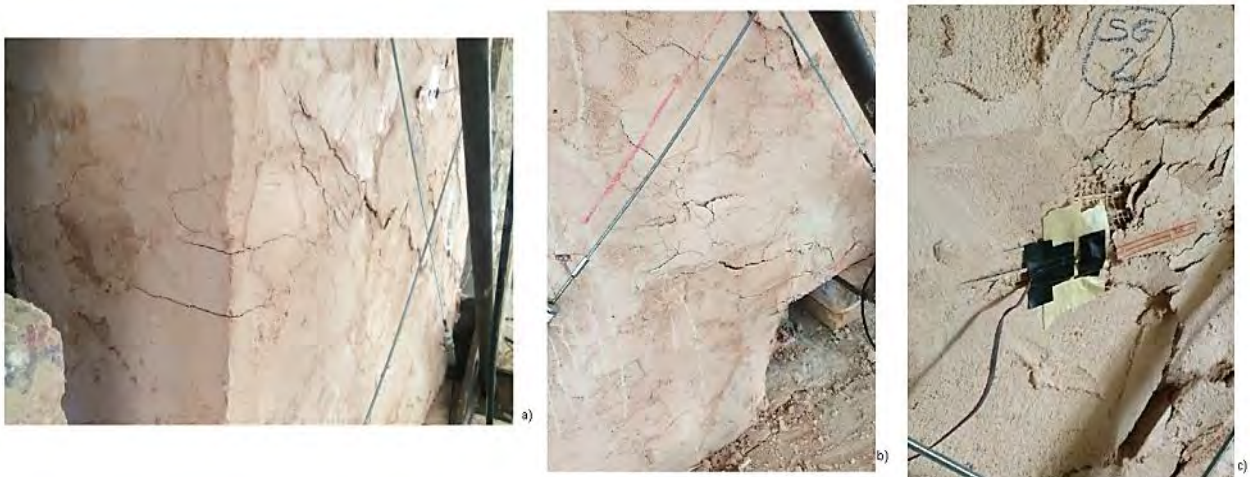
Figura 141 – Quadro fessurativo indotto dalla presenza del tessuto sul prodotto opus srg
