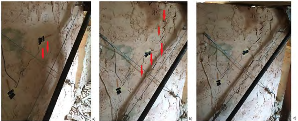
Figura 138 – Evoluzione del quadro fessurativo lato A
