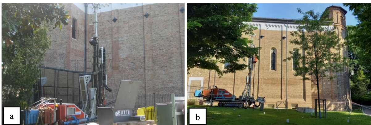
Figura 2.1. Procedure di realizzazione delle perforazioni: a) sondaggio P3, b) sondaggio P1 (dai certificati stratigrafici)
