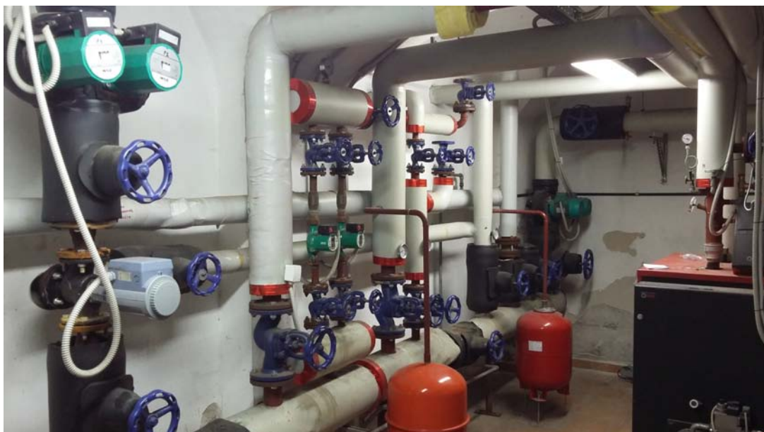
Figura 2.7 Centrale termica d'esempio. Sono visibili le pompe gemellate verdi di due dei quattro circuiti e la caldaia nell'angolo in basso a destra.
