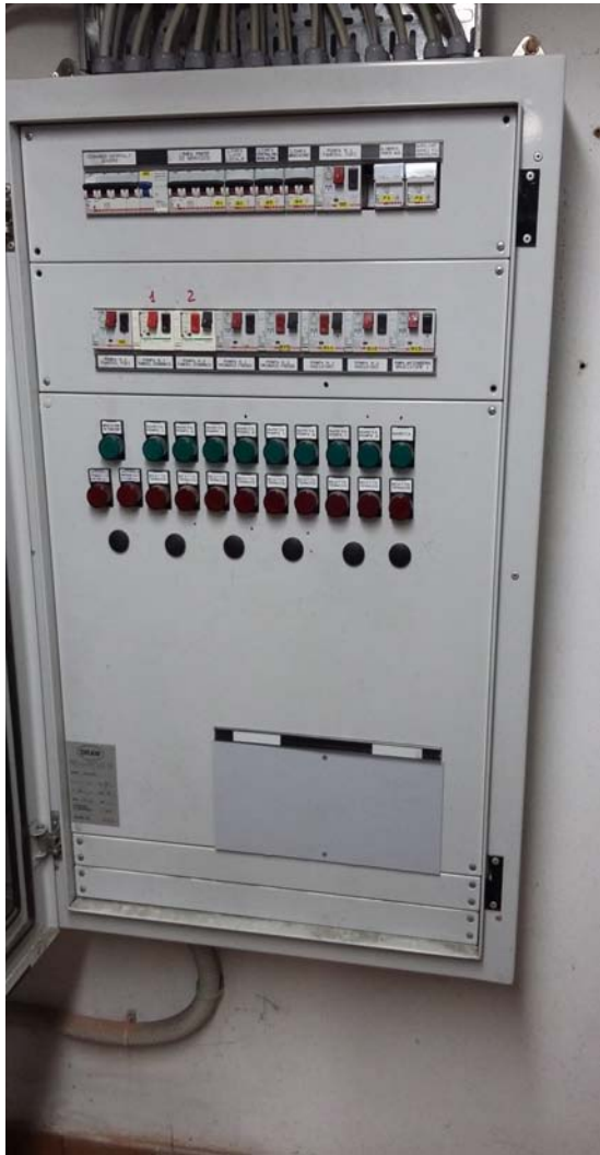
Figura 2.8 Quadro elettrico dotato di teleruttori e salvamotori con contatto di stato.
