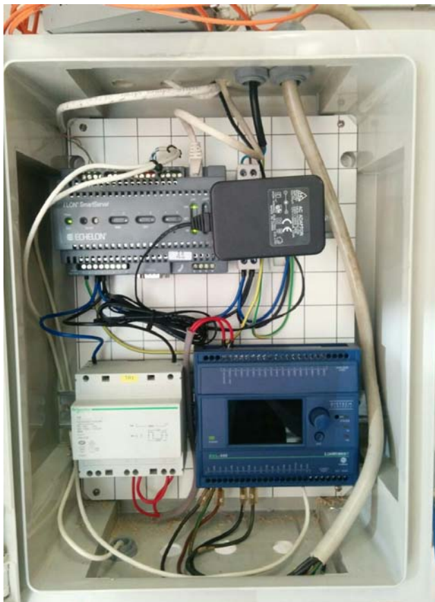
Figura 2.5 Nella figura si possono vedere lo smart server i.LON 100 in alto a sinistra e il controllore Disctech ECL350 in basso a destra.
