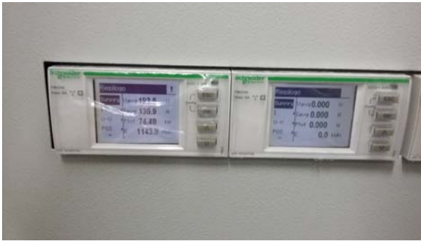
Figura 2.17 Strumenti per misura Schneider Electric PM3250 con informazioni veicolate tramite protocollo Modbus.
