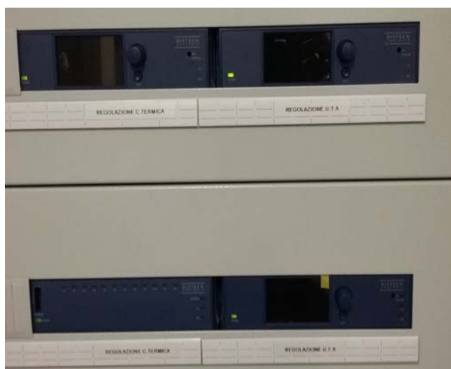
Figura 2.11 Sono visibili a partire dall'alto e in senso antiorario il controllore ECL 600 relativo alla centrale termica, i due controllori ECL 600 relativi al controllo della UTA con relativa espansione ECX 400.
