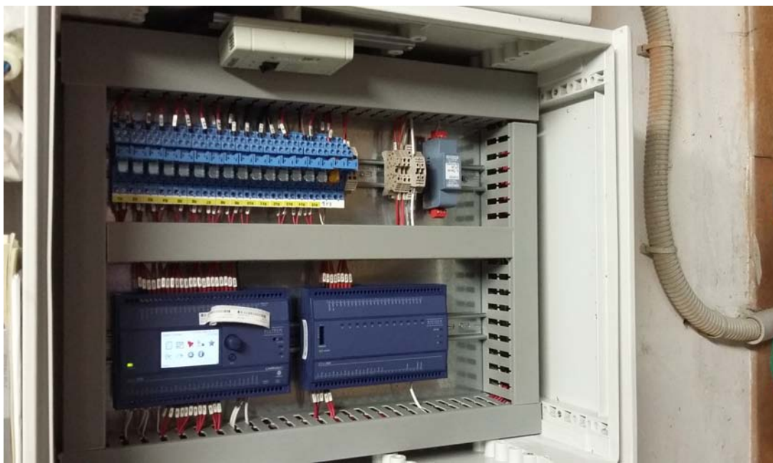
Figura 2.9 In basso si possono vedere il controllore ECL600 a sinistra con il relativo modulo di espansione ECX400. In alto a sinistra sono visibili i relè di appoggio ai teleruttori, mentre sulla destra in grigio si trova l'impedenza di terminazione.
