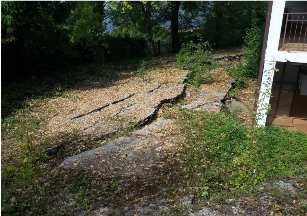
Fig.20: Cedimento dell'abitazione nel lato sud con presenza di fessure nel terreno.
