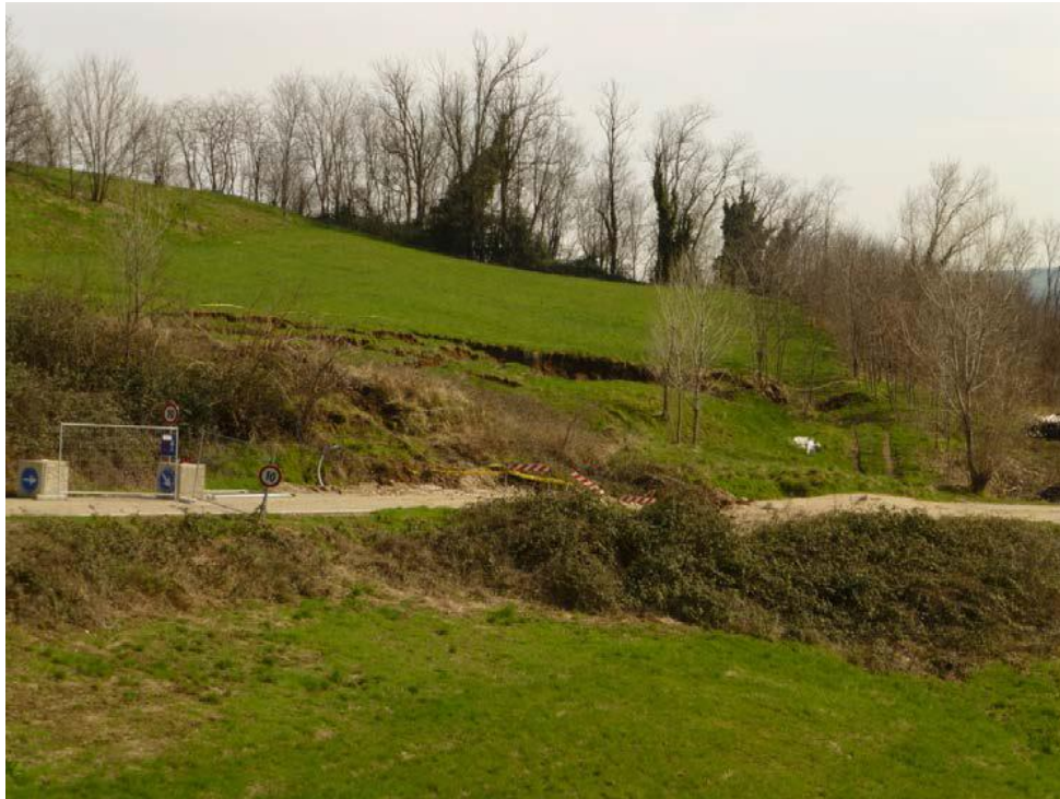
Fig.25: Strada comunale di Carrè coinvolta nell'area di dissesto (anno 2014), (Fonte: Toaldo,2014).
