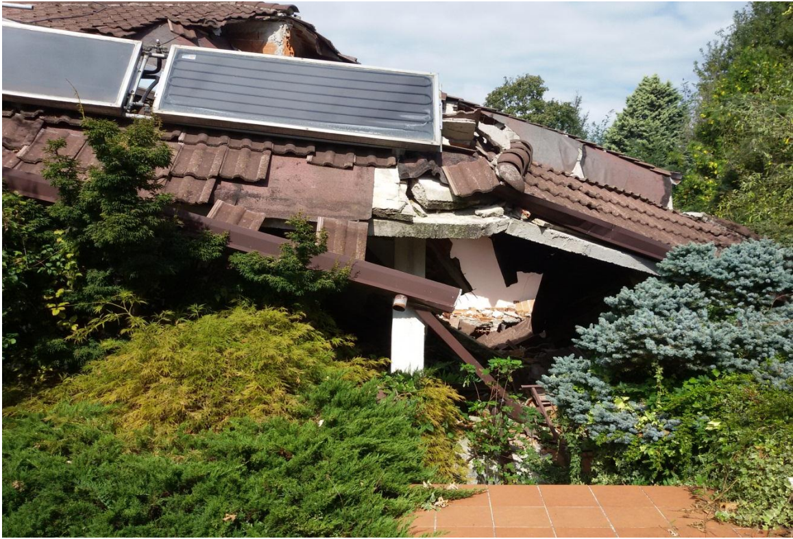
Fig.19: Crollo sul lato est dell'abitazione coinvolta nel dissesto di Fara Vicentino.
