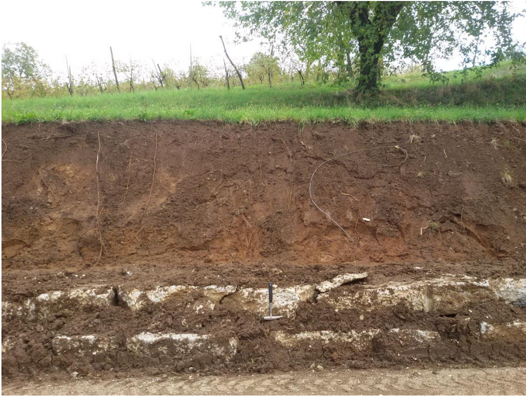
Fig.23: Dettaglio del margine superiore dell'area di dissesto ancora instabile a Fara Vicentino.
