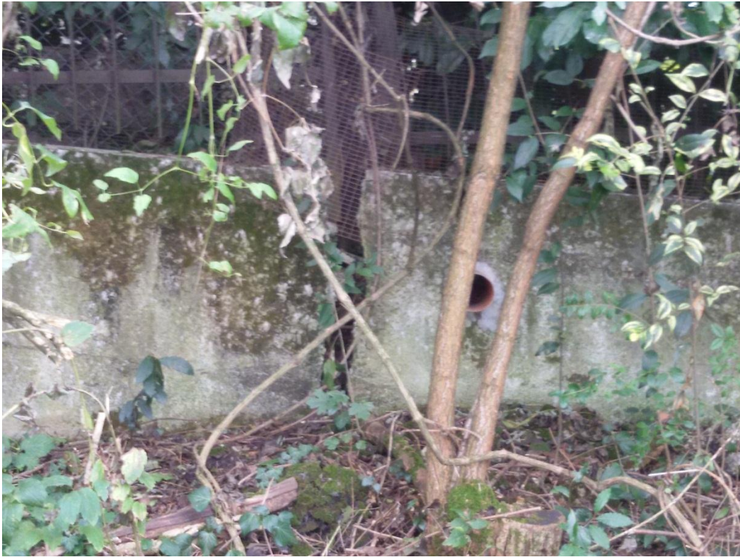
Fig.22: Rottura del muro di recinzione di proprietà dell'abitazione coinvolta.
