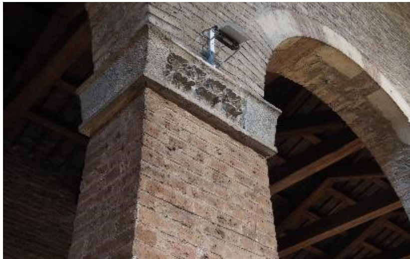
Fig. 90, Dettaglio del frammento di capitello del primo pilastro di sinistra, della chiesa dei Santi Felice e Fortunato di Vicenza, così come lo si vede oggi, (© Giada Cattani). Evidente è l'integrazione fatta per completare il capitello, a linee semplici e non ad imitazione del motivo fogliaceo del capitello antico.
