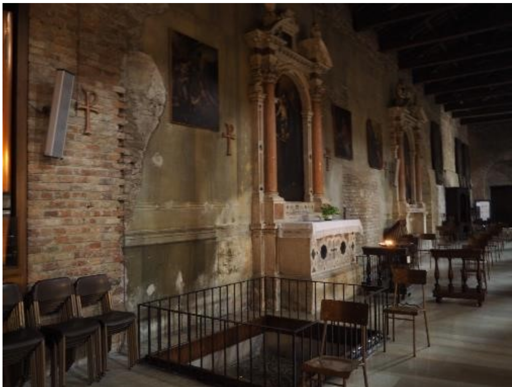
Fig. 113, Veduta attuale di un tratto del lato sud della navata destra della chiesa dei Santi Felice e Fortunato di Vicenza così come si presenta oggi. Sono visibili, fra gli altari barocchi mantenuti, delle tracce di pittura barocca, (© Giada Cattani)
