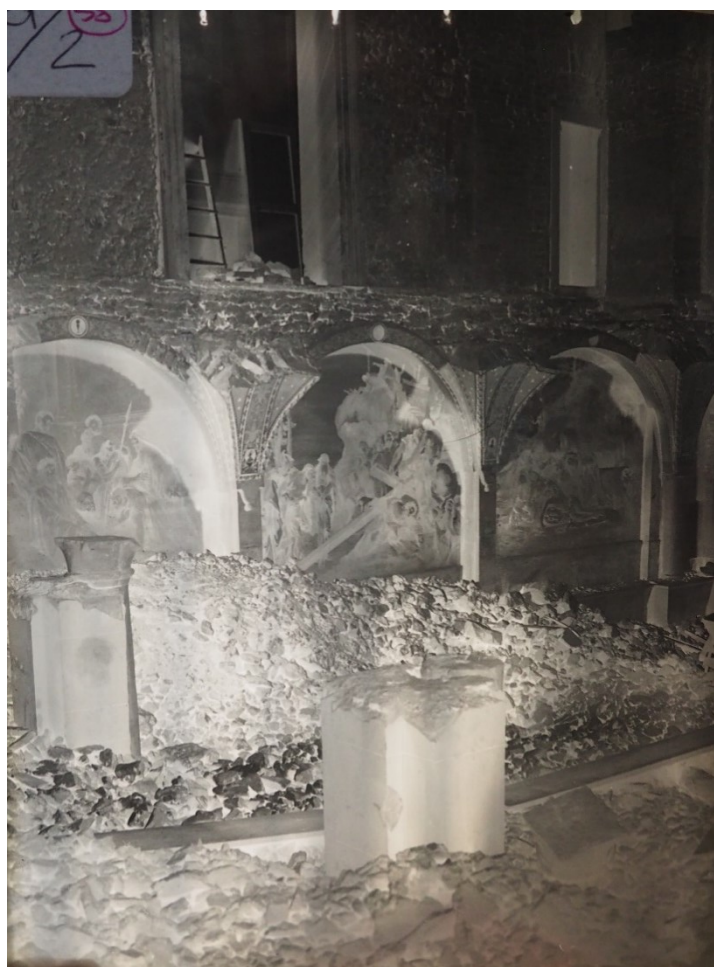
Fig. 74, Foto su lastra che ritrae la cripta durante la demolizione degli anni Trenta del Novecento. La foto è tratta
