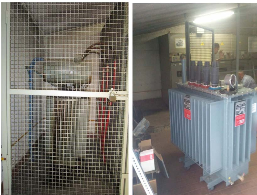
Figura 24: a sinistra: immagine del vecchio trasformatore del 1961. Dalla foto si può intravedere il trasudamento d'olio dovuto al funzionamento in sovraccarico; a destra: installazione del nuovo trasformatore a basse perdite da 250kVA.
