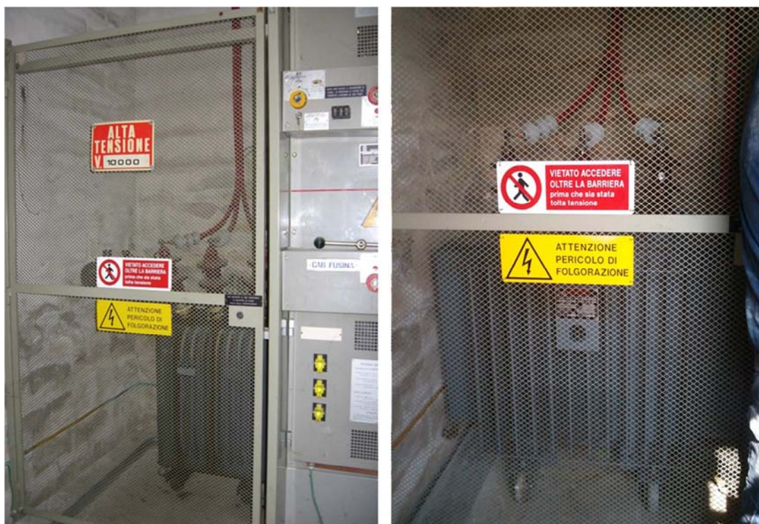
Figura 30: A sinistra: il box con il vecchi Tr da 63kVA; a destra: il nuovo Tr da 250kVA.
