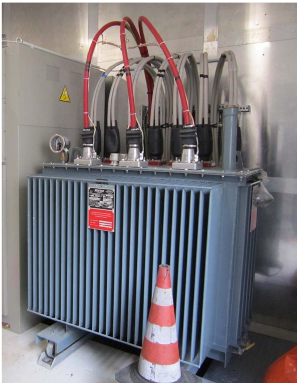
Figura 16: Trasformatore a basse perdite della Newton installato nella cabina «Piazza Plebiscito».
