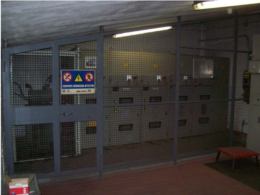
Figura 19: Foto estratta da DBC che raffigura l'interno della cabina 290931 Fossetto.
