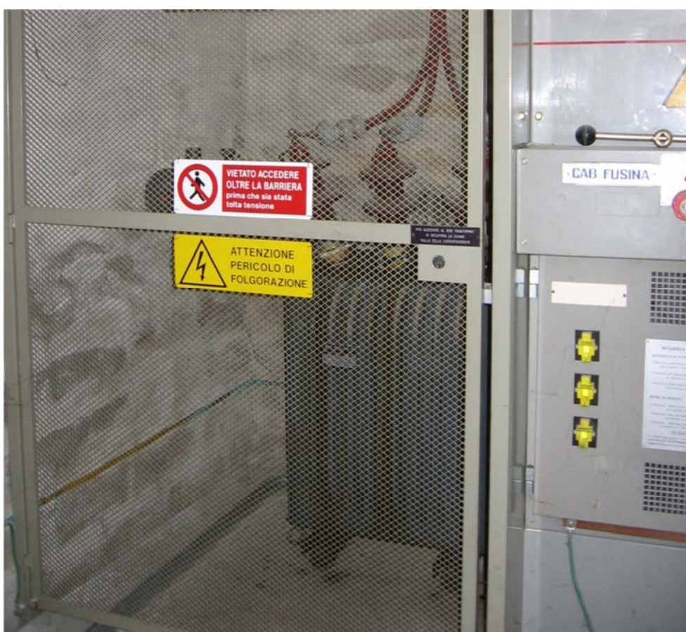
Figura 26: Foto del trasformatore da 63kVA della cabina Cavolo presente in DBC.
