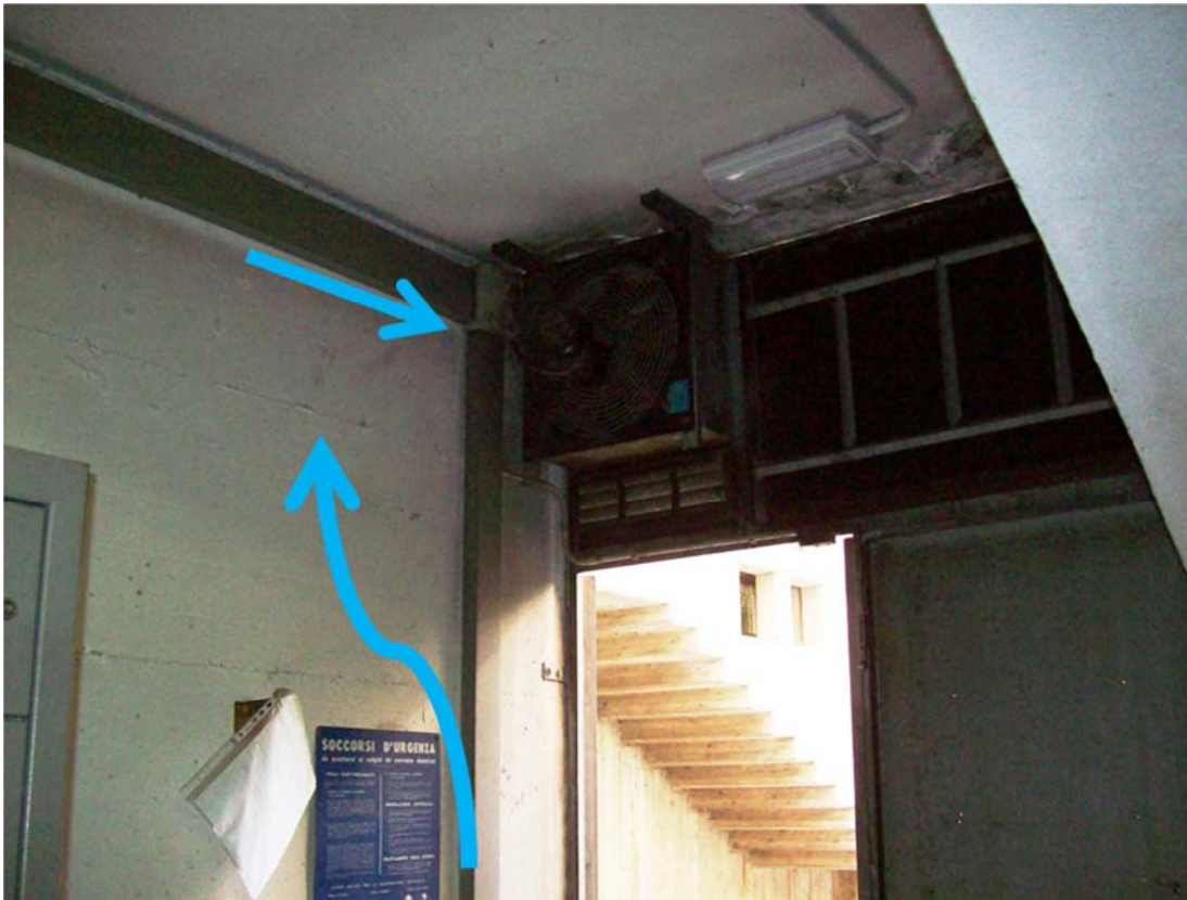
Figura 22: Foto relativa al punto di sfogo dell'aria relativa alla cabina Fossetto.
