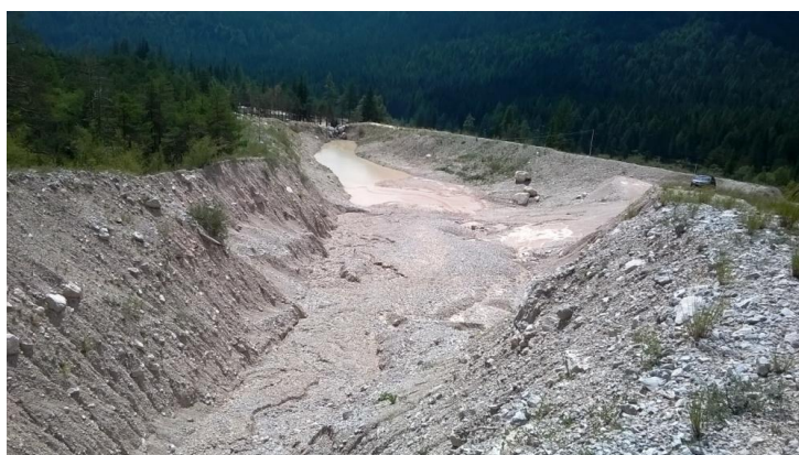
Fig. 1.8 - Bacino di ritenzione dei sedimenti, 4 agosto 2017
