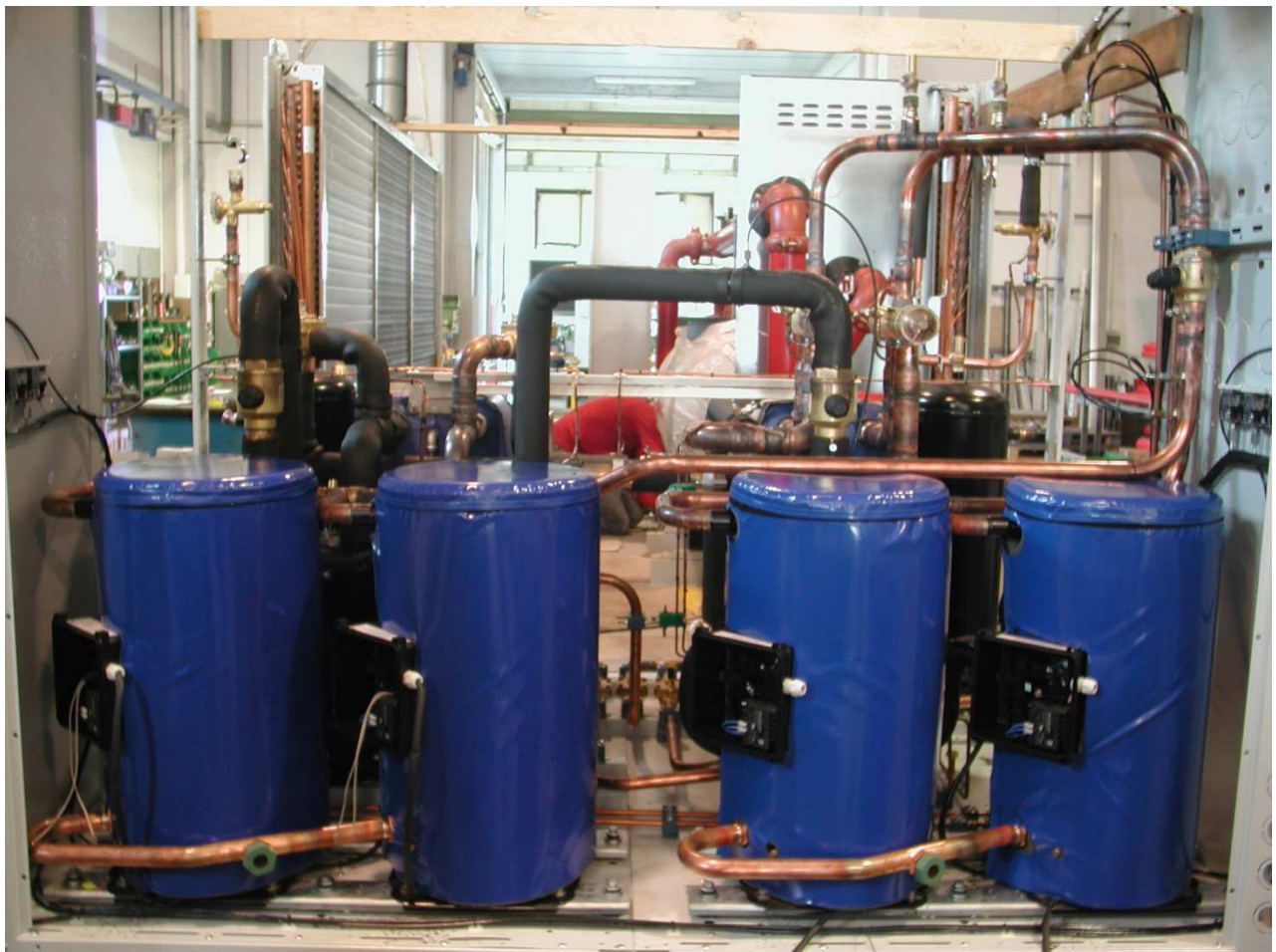
Figura 6-2: Particolare dei 2 tandem di compressori Copeland già inseriti nella cuffia afonica.
