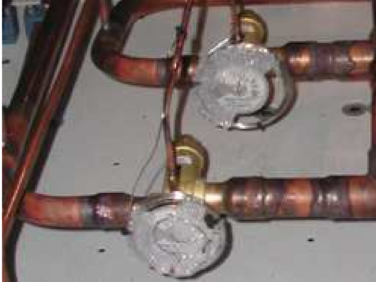
Figura 6-22: Valvole termostatiche installate sull'unità.
