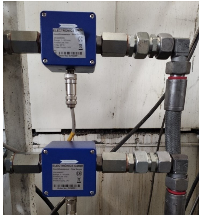
Figura 5.11 – Flussometri installati sulla pressa, forniti da Electronics GmbH.
