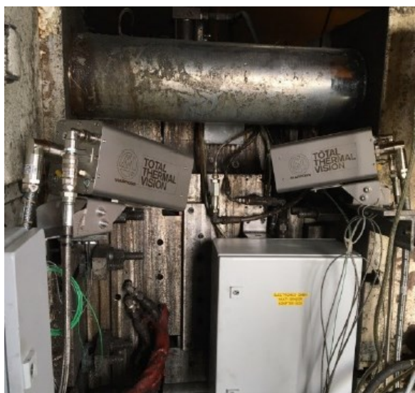
Figura 5.9 – Termocamere TTV Marposs installate sulla pressa.
