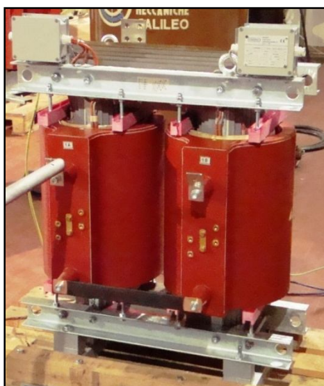
Figura 8.2.2(1): Trasformatore monofase Amadori da 220 kVA inserito nel circuito di prova delle scariche parziali
