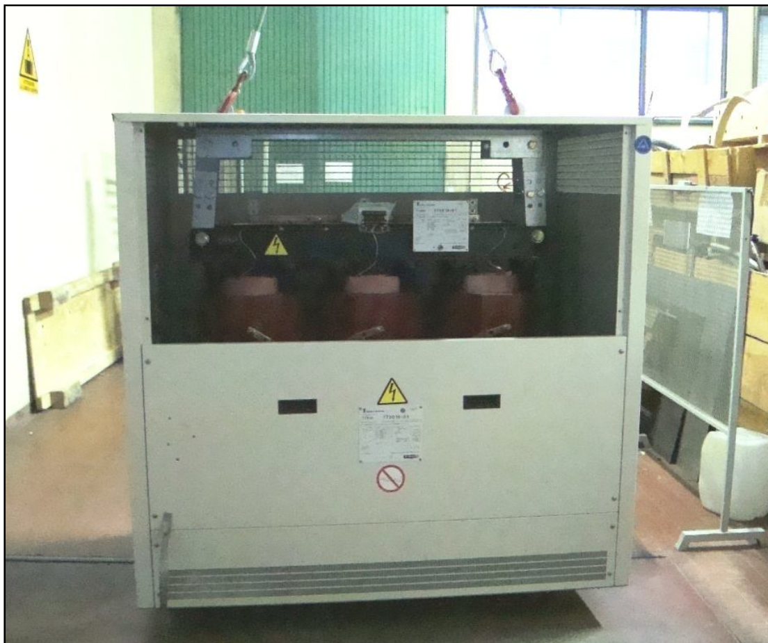
Figura 8.3.2(1): Trasformatore trifase isolato in resina epossidica con cabina France Transfo da 400 kVA Fonte: Archivio personale foto per tesi di laurea specialistica – Bottega Luca
