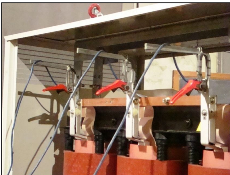
Figura 8.3.2(5): Particolare del circuito di rilievo delle scariche parziali. Procedura di prova speciale con un punto del triangolo a terra. Bobine secondarie alimentate alla frequenza di 100 Hz. Collegamento secondario a stella ( sbarra orizzontale di rame ). Fonte: Archivio personale foto per tesi di laurea specialistica – Bottega Luca
