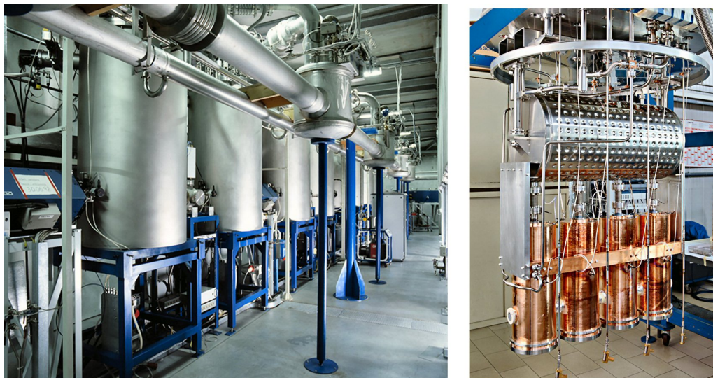
Fig. 1.17: A sinistra è rappresentato un tratto del linac ALPI. In evidenza i criostati, recipienti che contengono ed isolano termicamente dall'ambiente circostante le cavità superconduttiva (a T = -269^{\circ}C ). L'interno di un criostato, con 4 cavità acceleranti su base di rame, è mostrato sulla destra.
