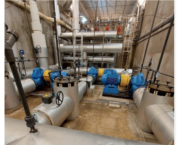
Sala macchina di un impianto SWAC di Tetiaroa.
