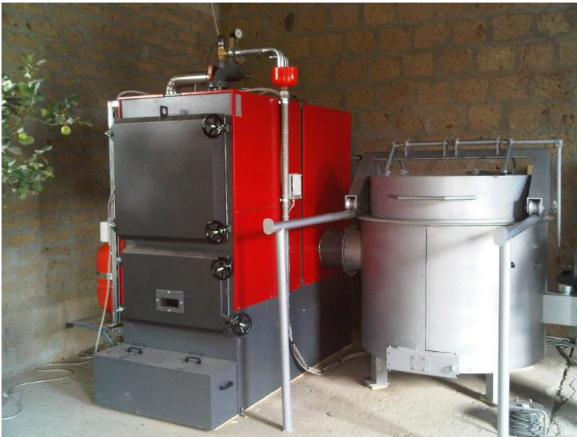
FIGURA 9.4 : VISTA ESTERNA GASSIFICATORE LOSI
