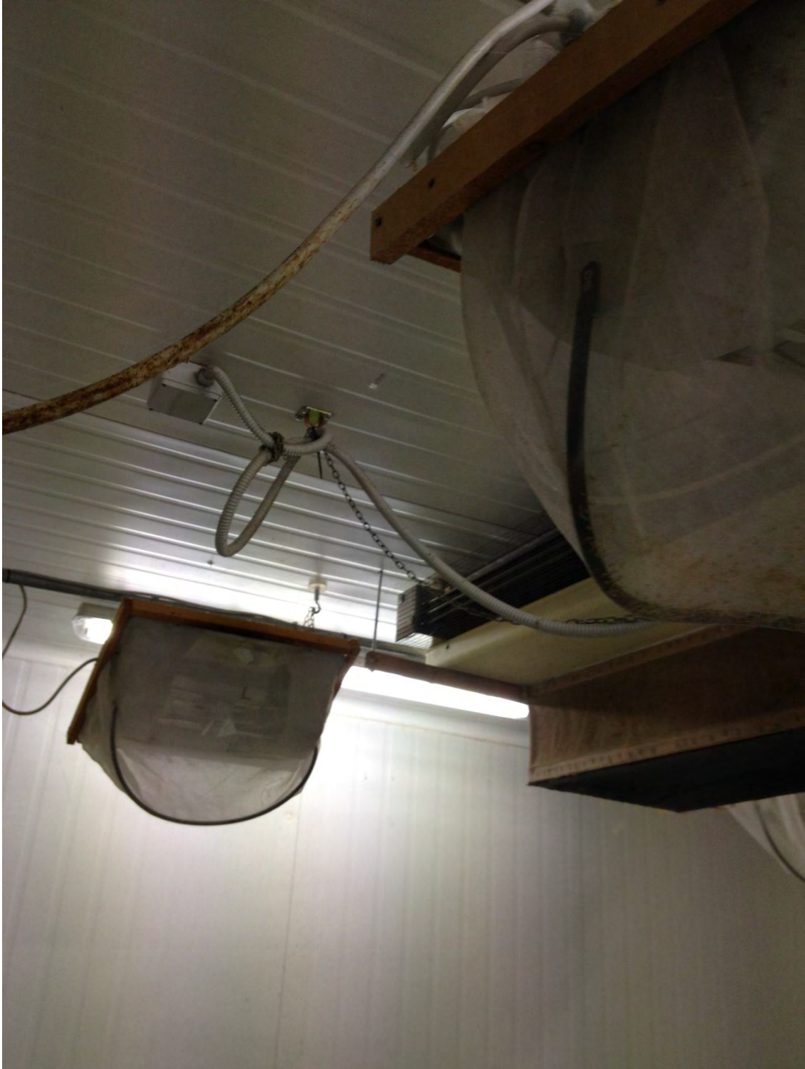
Figura 45: Dettaglio lampada HPS SON T
