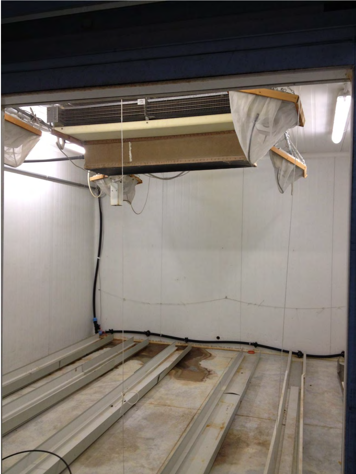
Figura 44: La cella di prova ante-opera. Le lampade HPS sono circondate da una retina
