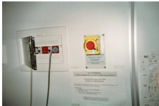
Figura 2.25 - Filtri elettrici e pulsante di Quench
