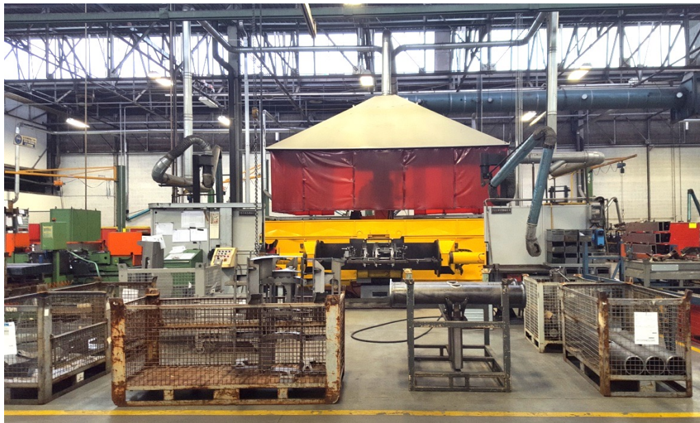
Figura 4.42 Immagine dell'area dell'accoppiamento supporto assale posteriore saldato 5SC e muffler frame Robot 89.51
