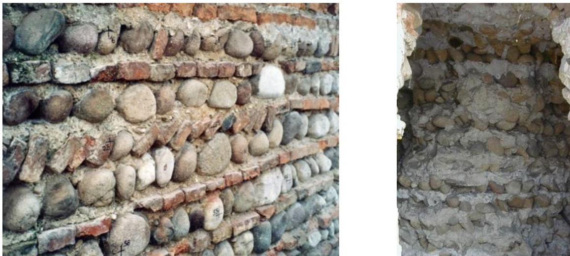
Fig. 4.8 – Tessitura muraria dei paramenti esterni (sinistra) e del riempimento interno (destra) della cinta muraria (Da Porto, 1999).
