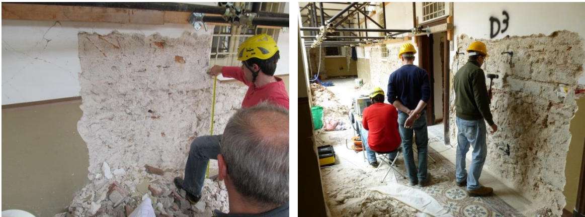
Fig. 4.1 – Individuazione di un pannello significativo ai fini dell'indagine (sinistra) ed esecuzione di una prova in una zona complessa ma accessibile agli operatori e alla strumentazione (destra).
