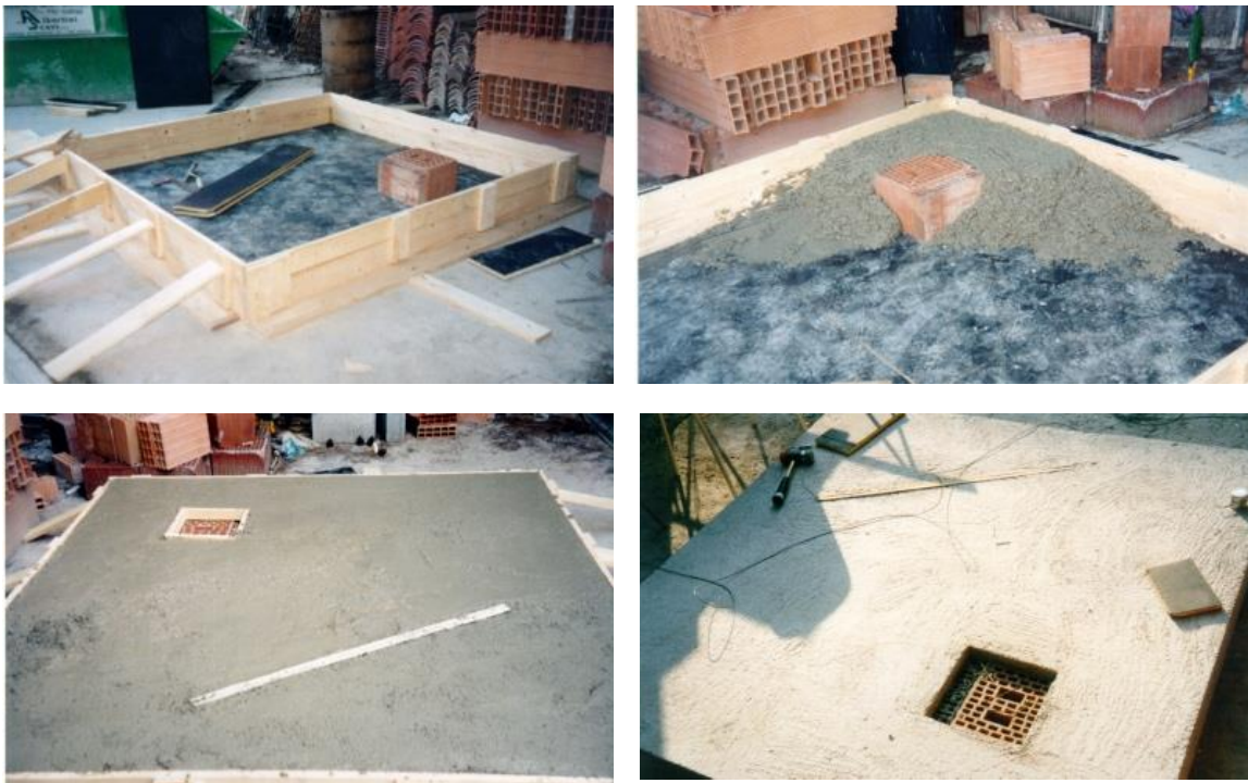
Fig. 7.5: Quattro particolari della fase di esecuzione: la disposizione degli elementi interni (alto-sinistra), il getto del calcestruzzo (alto-destra), la lastra terminata (basso-sinistra) e pronta per l'esecuzione della prova tomografica (basso-destra) (Monteforte, 1998).
