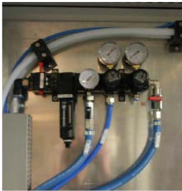
Figura 26 Unità di servizio dell'aria compressa
