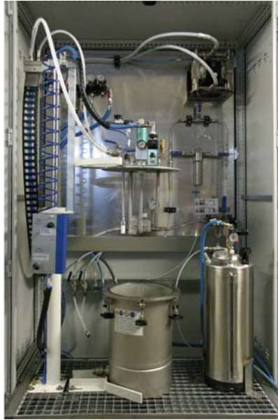
Figura 24 Armadio di alimentazione della vernice
