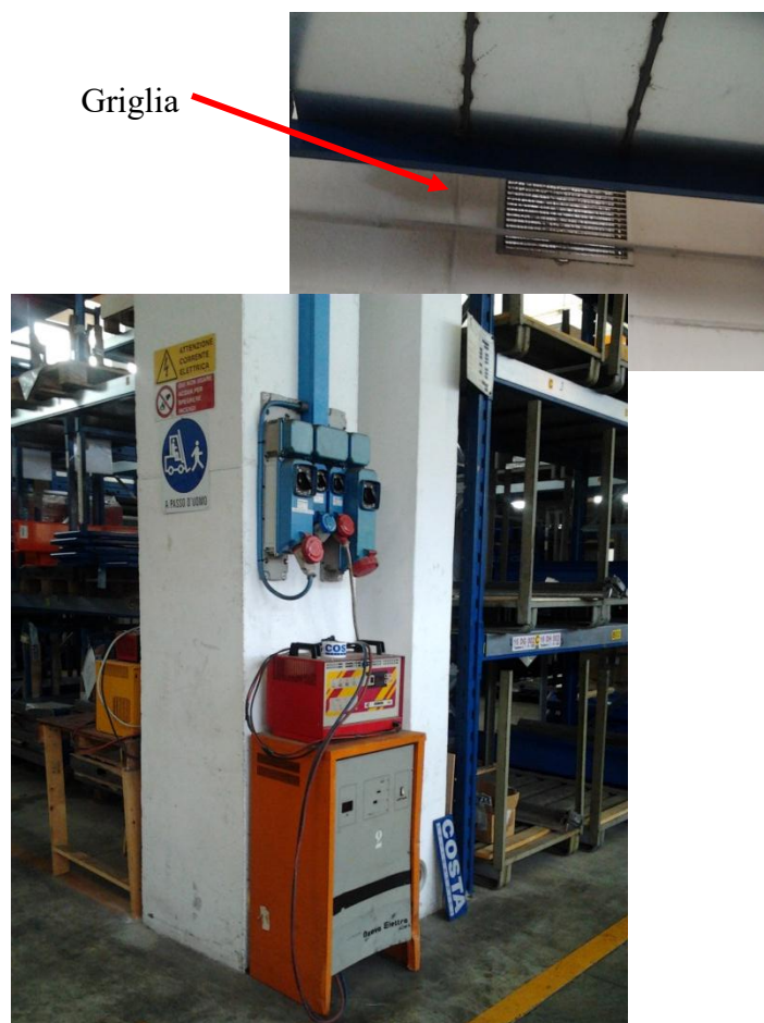
Figura 9.2.3 : Zona ricarica Schio, interna, provvista di areazione
