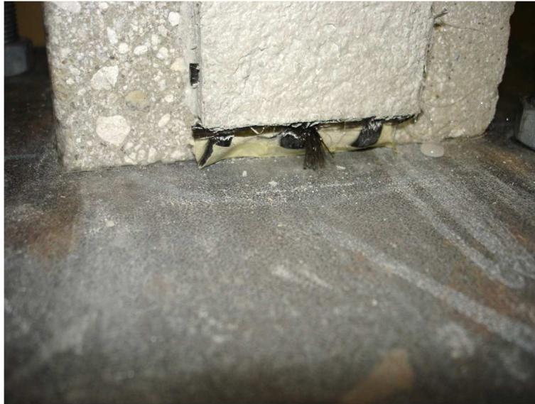
Fig. 6.26 – Particolare delle fibre non delaminate nella parte inferiore della matrice.
