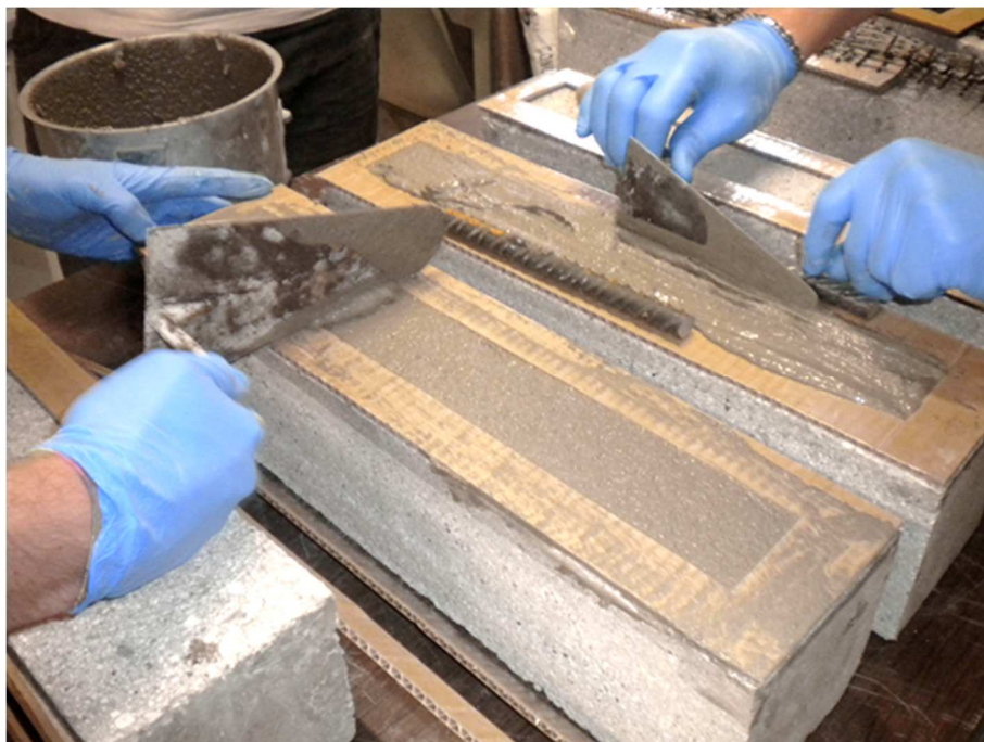
Fig. 5.2 – Stesura del primo strato di matrice Rock S all'interno del cassero inferiore.
