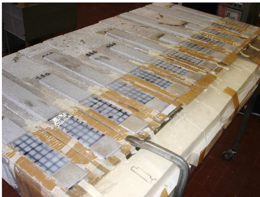
Fig. 5.6 – Impregnazione delle fibre esterne con resina ed applicazione di piastre in alluminio.
