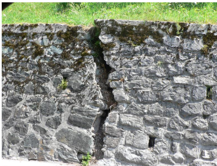
Fig. 26: Muro di sostegno deformato per effetto della spinta del corpo di frana.
