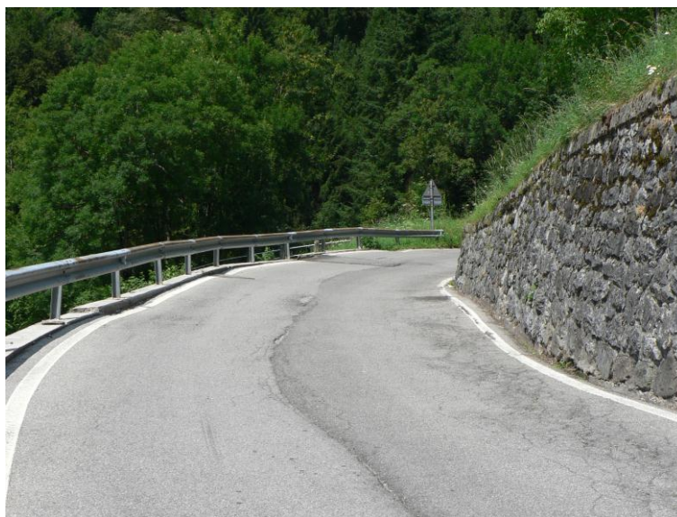
Fig. 25: Deformazione della pavimentazione stradale.
