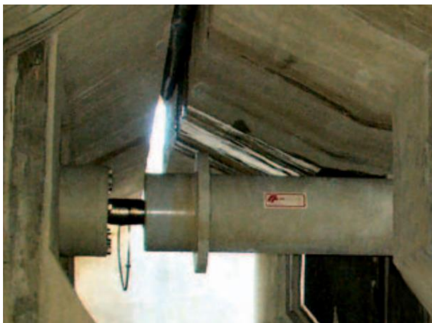
Figura 4.12: Un dissipatore viscoso ricentrante installato
