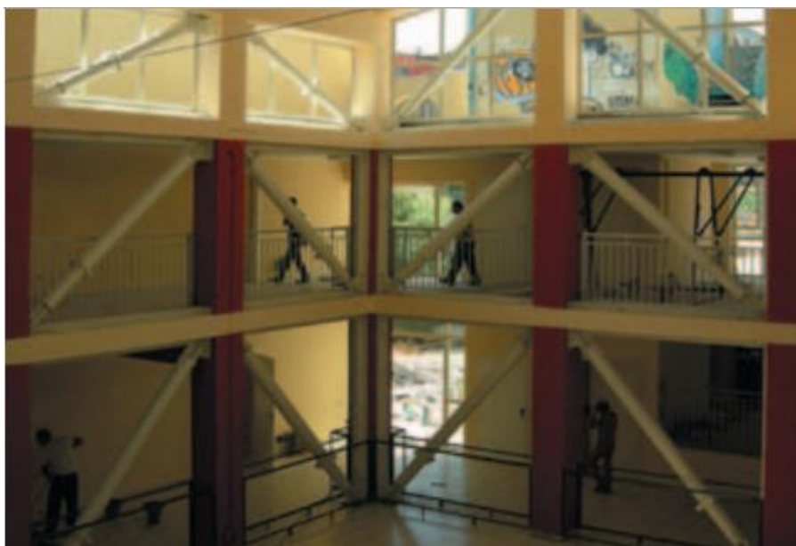
Figura 4.13: Dissipatori installati nella scuola Cappuccini a Ramacca (CT)
