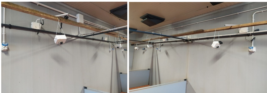
Fig. 32a, 32b – disposizione delle centraline e dei sensori termici nei box
