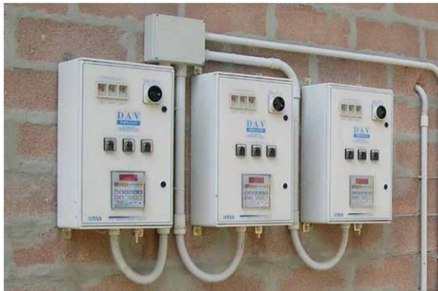
Fig. 6 – centraline elettriche per il controllo della ventilazione (Rossi P et al., 2013)
