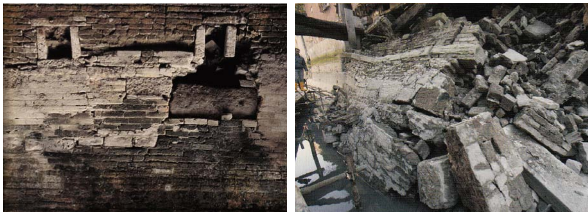
Fig.3.12,3.13 Documentazione fotografica del degrado dovuto all'ingresso delle acque in circolazione all'interno dei gatoli , tratta da Insula Spa, Venezia manutenzione urbana-Insula: 10 anni di lavori per la città , Treviso, 2007
