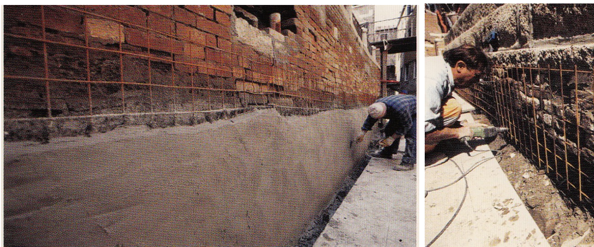
Fig.5.13 Alloggiamento della rete metallica di supporto; Fig.5.14 Rivestimento con malta fibrorinforzata, tratte da Insula Spa, Venezia manutenzione urbana-Insula: 10 anni di lavori per la città , Treviso, 2007
