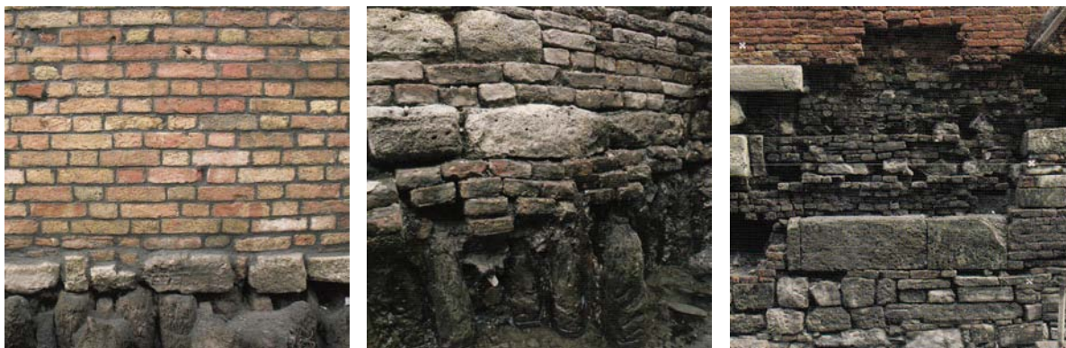
Fig.3.9,3.10,3.11 Documentazione fotografica dello stato di conservazione della base d'imposta delle fondazioni e dei fenomeni di degrado connessi alla presenza delle acque lagunari, tratta da Insula Spa, Venezia manutenzione urbana-Insula: 10 anni di lavori per la città , Treviso, 2007
