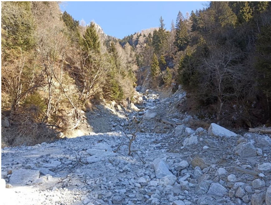
Figura 5.3.3: Deposito a monte della seconda briglia di consolidamento
