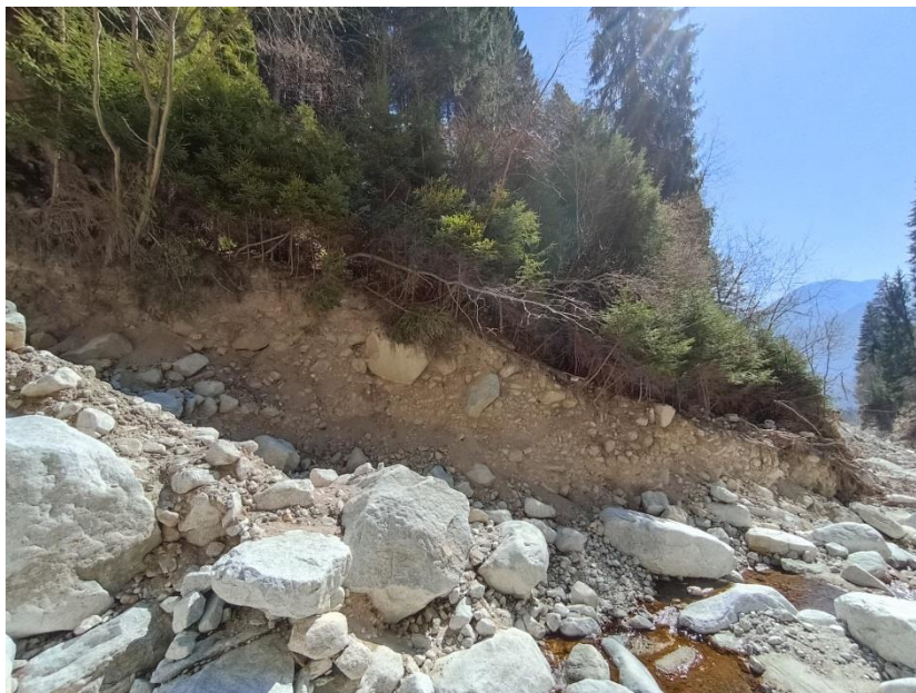
Figura 5.3.4: Erosione a valle della quarta briglia di consolidamento
