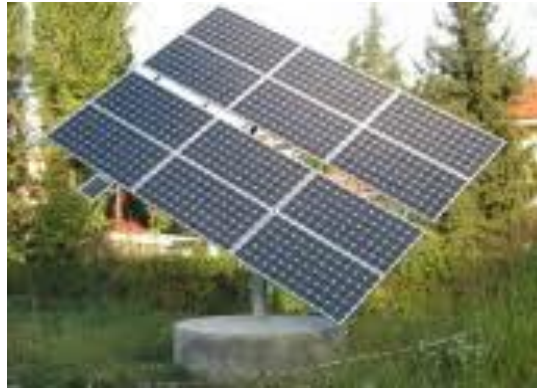
Fig. 4.4.: pannello ad inseguimento attivo
