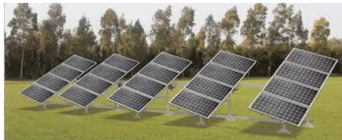
Fig. 4.5.: pannello ad inseguimento passivo
