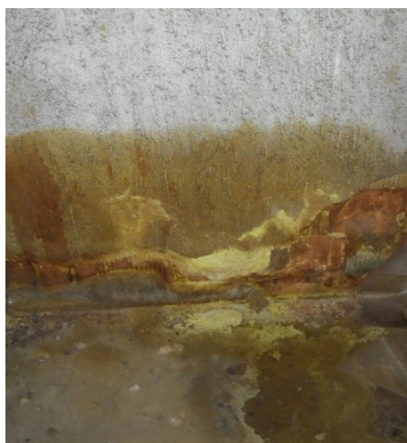
Figura 6. Evidente contaminazione da Cr(VI) nel muro e nella pavimentazione.
