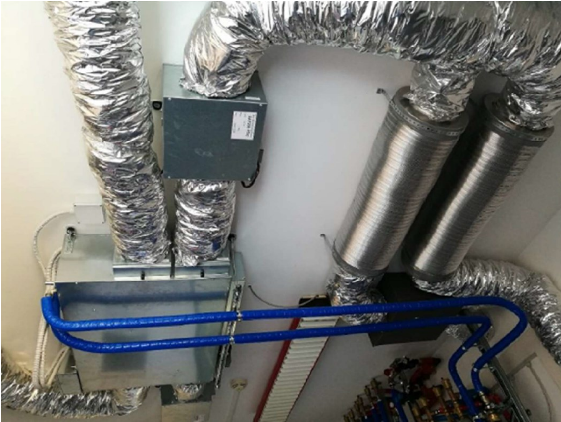
Figura 1.10 – Immagine dell'unità di VMC e dei collegamenti con i circuiti primari di riscaldamento e raffreddamento (tubazioni blu)
