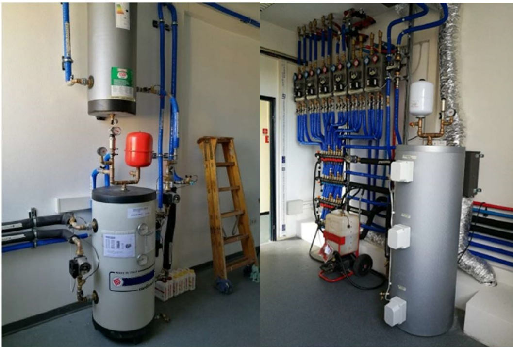
Figura 1.11 – Serbatoio di raffreddamento e collegamento con il circuito del chiller (sinistra); serbatoio di riscaldamento e circuiti secondari (destra)
