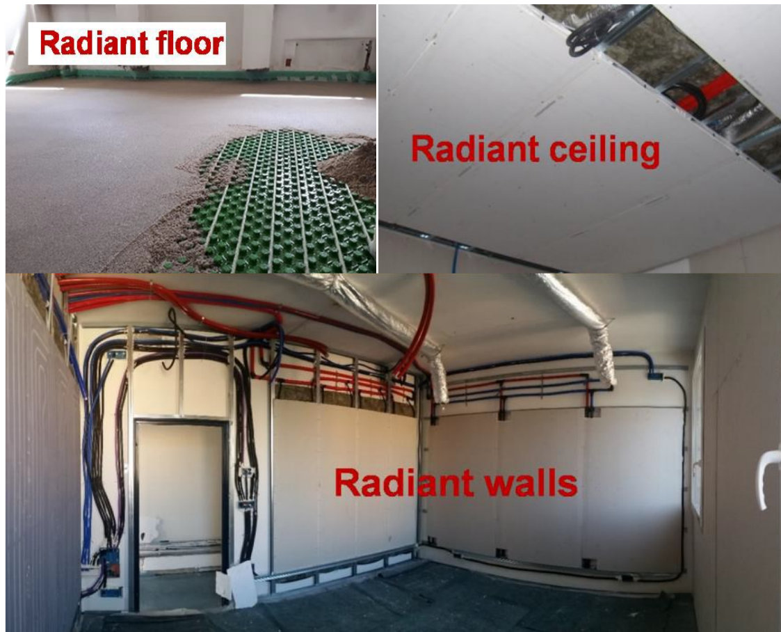
Figura 1.3 – Sistemi radianti installati nel laboratorio CORE-CARE
