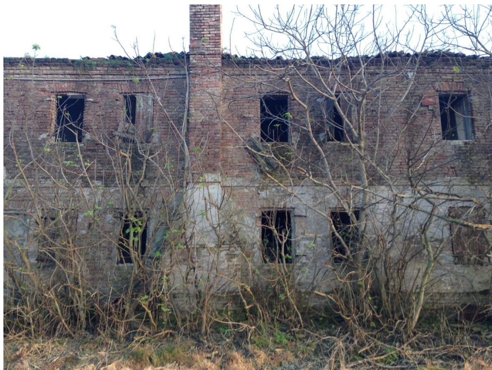
Figura 4.7: Particolare del camino esterno nel prospetto Nord dell'abitazione.
