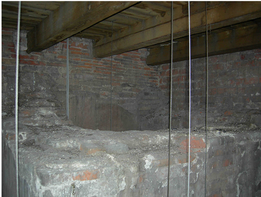
Fig.A.6.15 – Particolare sommità cisterna d’acqua. Si noti l’impalcato ligneo della cella campanaria.
