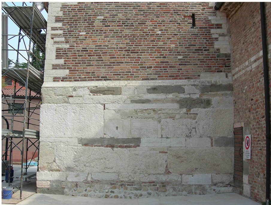
Fig.A.5.4 – Vista fronte ovest. Base della torre. A destra la porta d'accesso all'interno.
