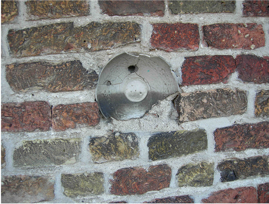
Fig.A.5.5 – Lato ovest quota circa 15m. Curioso inserto nella muratura, forse a copertura di un buco di proiettile di bombarda.
