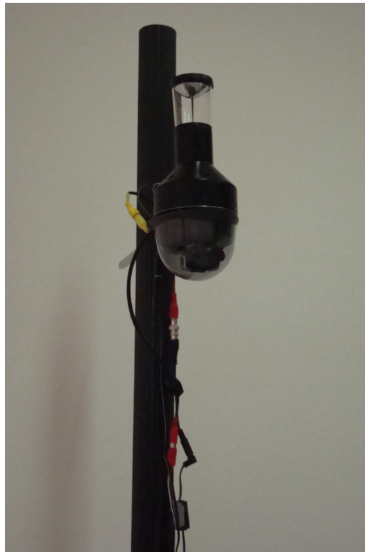
Figura 1.3: La telecamera panoramica OmniDome e la PTZ solidali sullo stesso palo.
