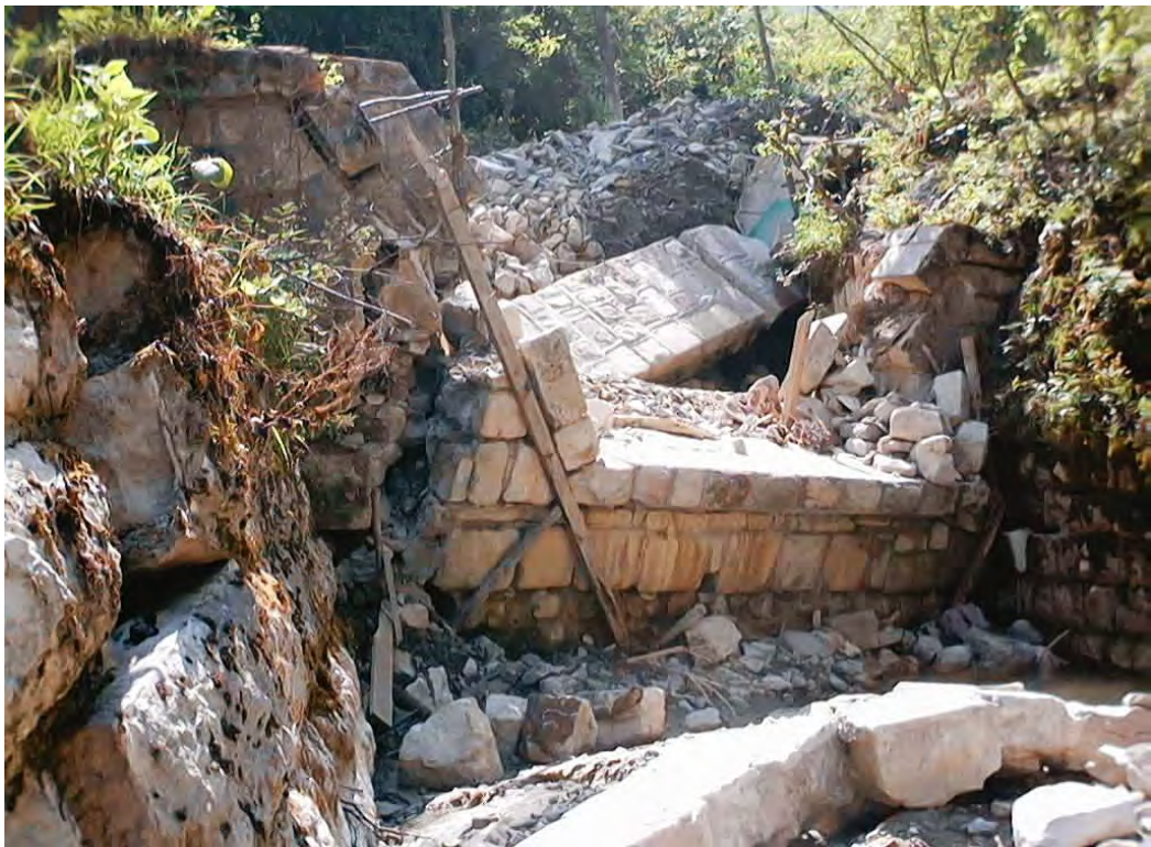
Figura 1.16 - Briglia danneggiata dalla ripresa dei movimenti (internet, www.tesaf.unipd.it )
