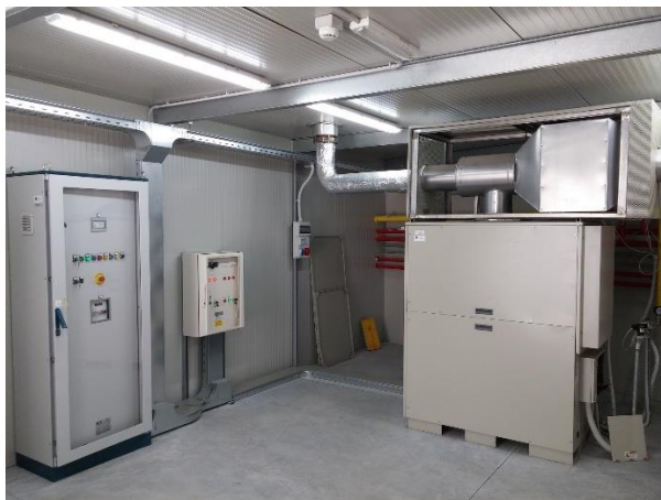
Fig. 2.5 Immagine della microturbina
