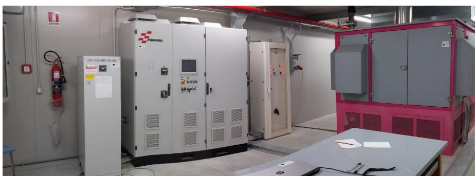
Fig. 2.3 Immagine del cogeneratore
