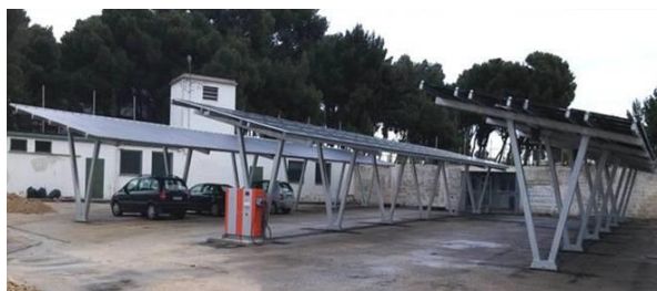
Fig. 2.6 Immagine dell'impianto fotovoltaico
