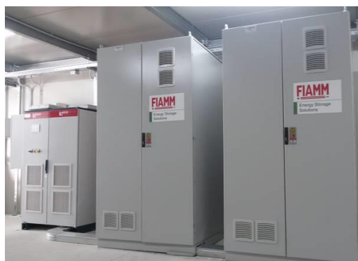
Fig. 2.7 Immagine del sistema di accumulo
