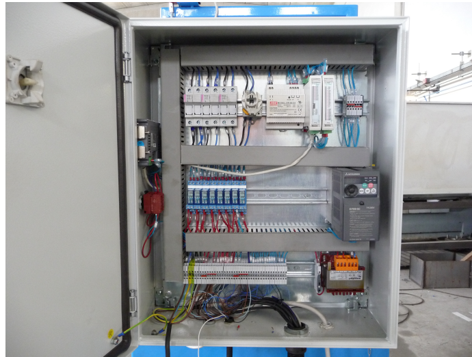
Fig. 4.2.2: Quadro elettrico della macchina
