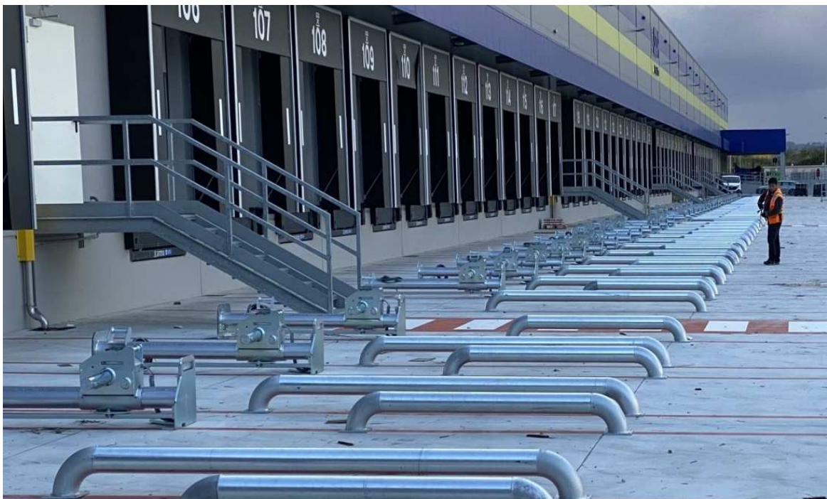
Figura 7.14: accessi pedonali tra gli stalli per consentire il transito tra le banchine di carico esterne e l'interno dello stabilimento. Gli stalli sono provvisti di barriere fisse a protezione dei corridoi pedonali e utili anche al conducente in fase di manovra
