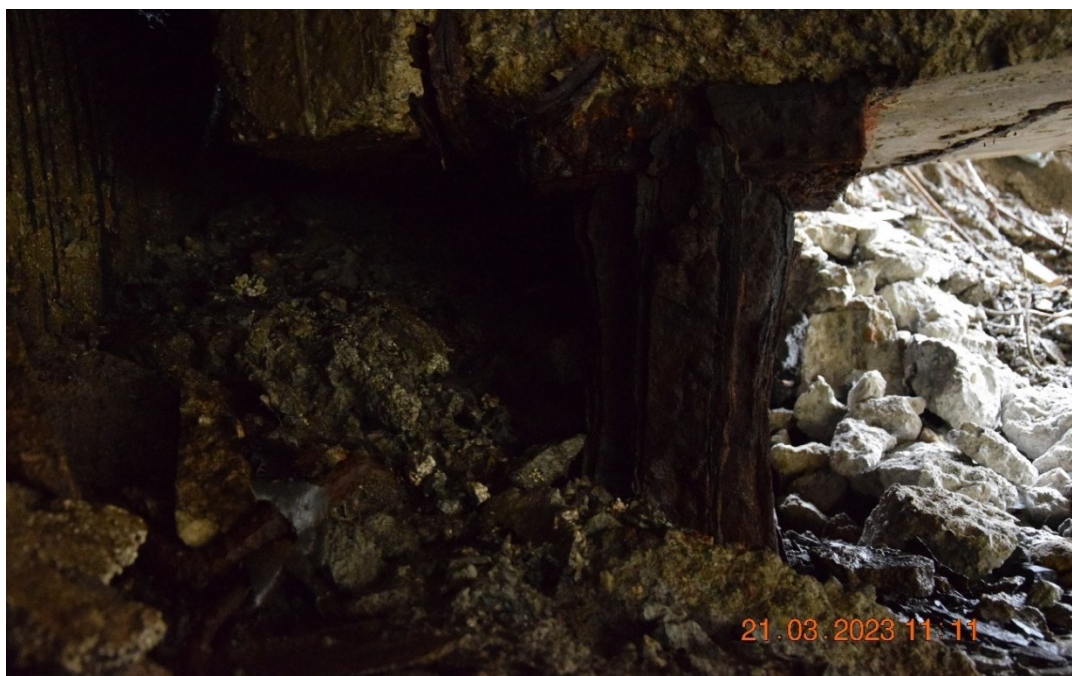
Figura 2-16 Viadotto Fosso Silicara, apparecchio d'appoggio - ossidazione (G=2), bloccaggio (G=4) e presenza di detriti (G=2)
