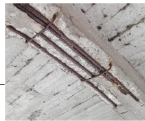
Figura 6-2 Scheda difettologica, distacco del copriferro (Allegato C, LLGG)
