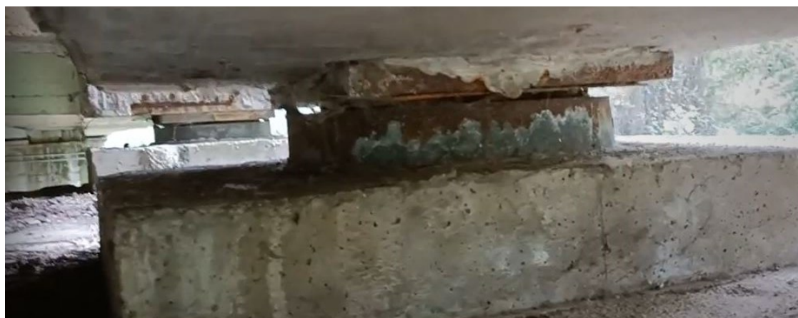
Figura 2-19 Viadotto Mavigliano, apparecchio d'appoggio - ossidazione (G=2)
