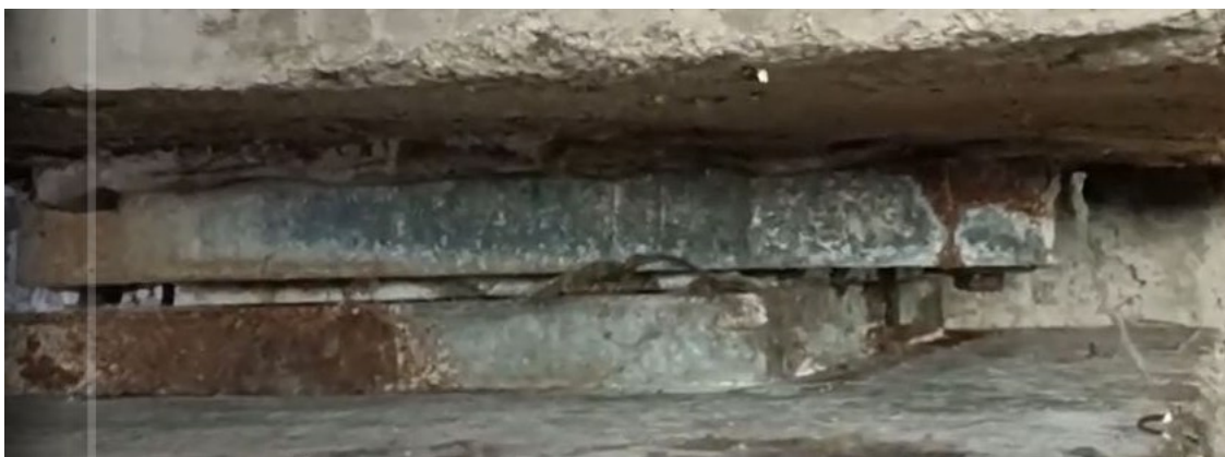
Figura 2-18 Viadotto Mavigliano, apparecchio d'appoggio - preregolazione sbagliata (G=4)
